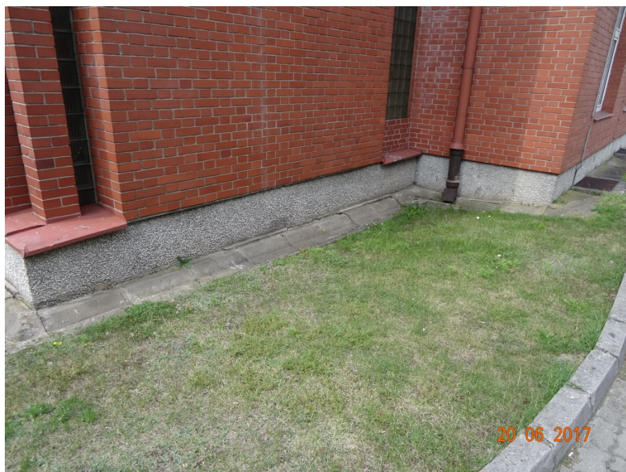
Fot. 14. Naroże pomiędzy ścianą tylną budynku zasadniczego i skrajnej klatki schodowej. Zapadnięte betonowe koryto, zbierające wody opadowe z terenu nachylonego w stronę budynku, bez wpustu burzowego (!?).
