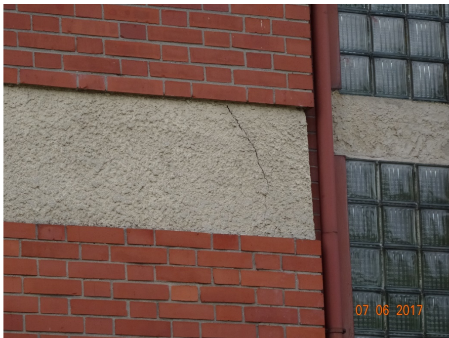
Fot. 11. Jak fot. 10, lecz zbliżenie na zarysowanie gzymsu w poziomie stropu nad parterem budynku zasadniczego.
