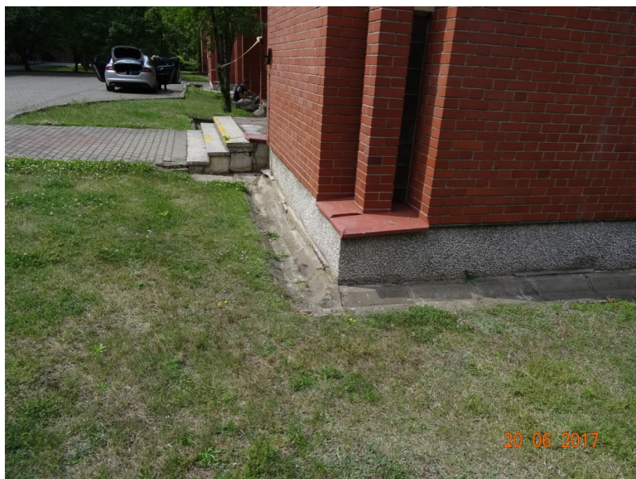
Fot. 15. Zapadnięte koryto odwadniające terenu nachylony w stronę budynku przy ścianie tylnej skrajnej klatki schodowej bez wpustu burzowego. Widoczne również zniszczenia schodów zewnętrznych.
