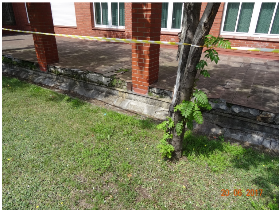
Fot. 47. Taras. Zniszczenia powierzchni czołowej.
