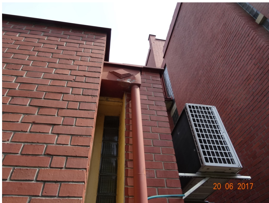
Fot. 31. Część parterowa od strony pld.-zach. Uszkodzone mechanicznie i dziurawe naczynie zbiorcze.
