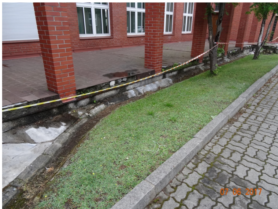
Fot. 49. Taras. Zapadnięte koryto odwadniające teren.
