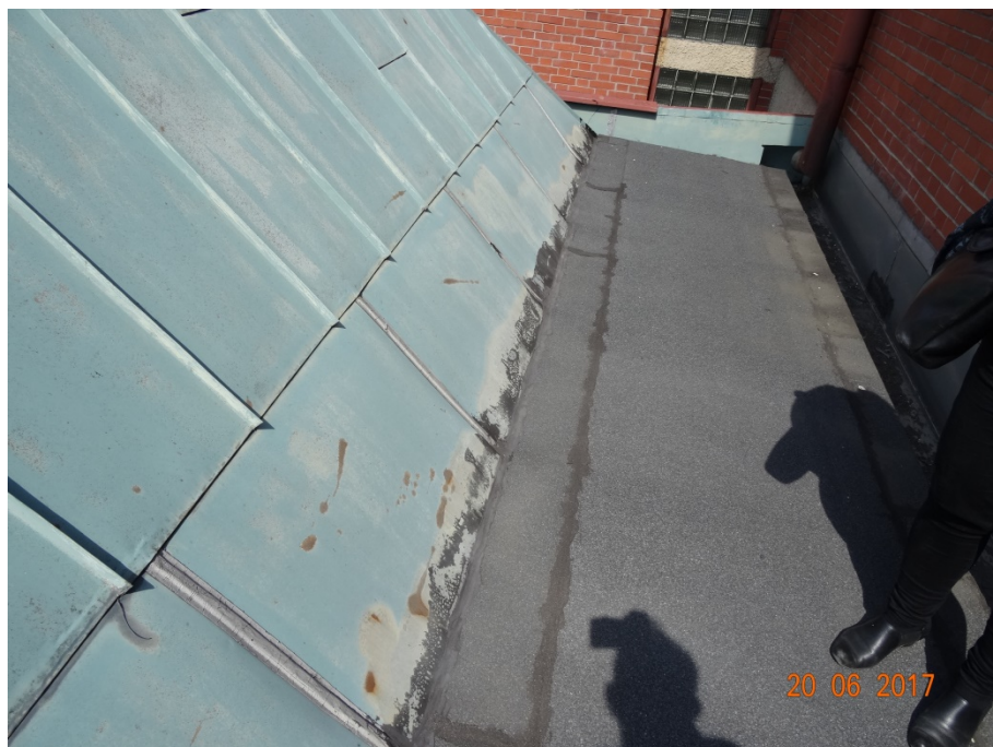
Fot. 37. Dach części parterowej. Fragment płaski od strony budynku zasadniczego pokryty papą ułożoną na pierwotnym pokryciu blaszanym. Brak prawidłowego połączenia papy z blachą. Widoczne również uszkodzenia korozyjne blachy.
