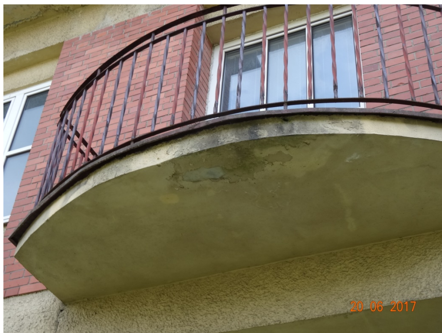
Fot. 6. Jak fot. 3, lecz zbliżenie na uszkodzenia płyty łukowego balkonu spowodowane spływaniem wody opadowej spod opierzenia blacharskiego.
