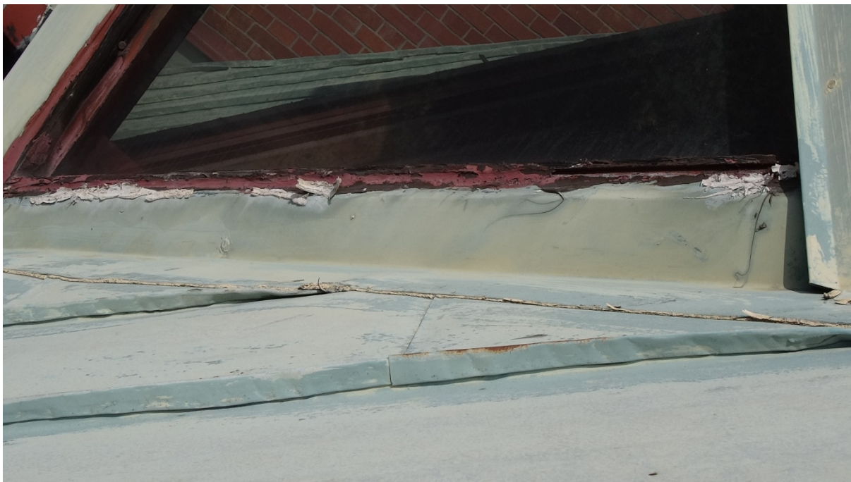
Fot. 43. Jak fot. 41, lecz zbliżenie na próg ościeżnicy. Widoczne wielokrotne uszczelnienia różnymi rodzajami kitów.
