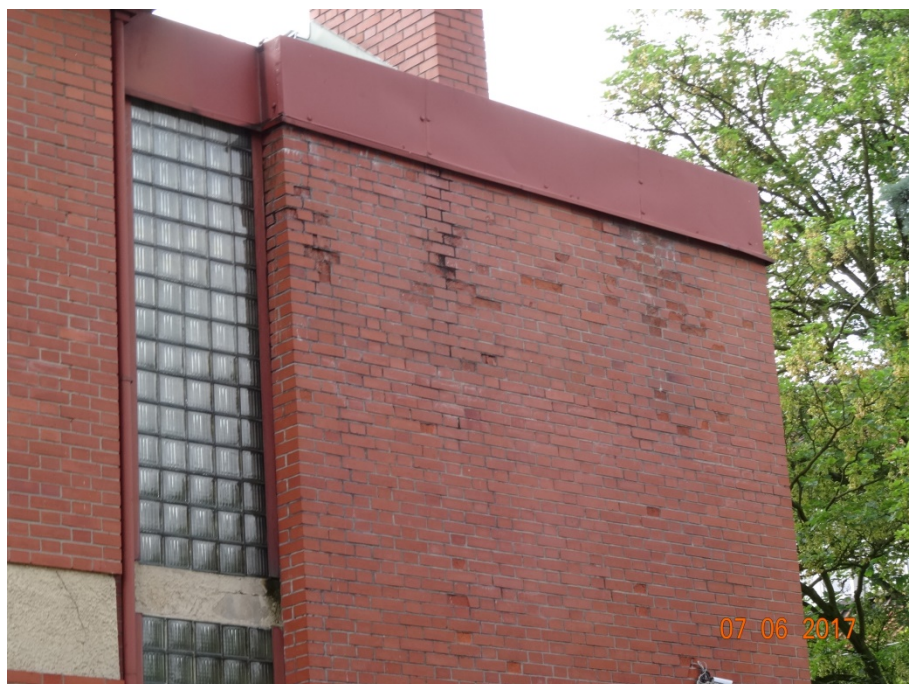
Fot. 21. Pn.-wsch. ściana boczna dwukondygnacyjnej części sanitarnej. Zbliżenie na złuszczenia cegieł klinkierowych warstwy osłonowej sanitariatów oraz uszkodzenia w poziomie wieńca stropowego pod luksferami. Widoczne również zarysowanie górnego fragmentu ściany na prawo od rury spustowej oraz ślady spływania wody opadowej spod opierzenia wieńczącego.
