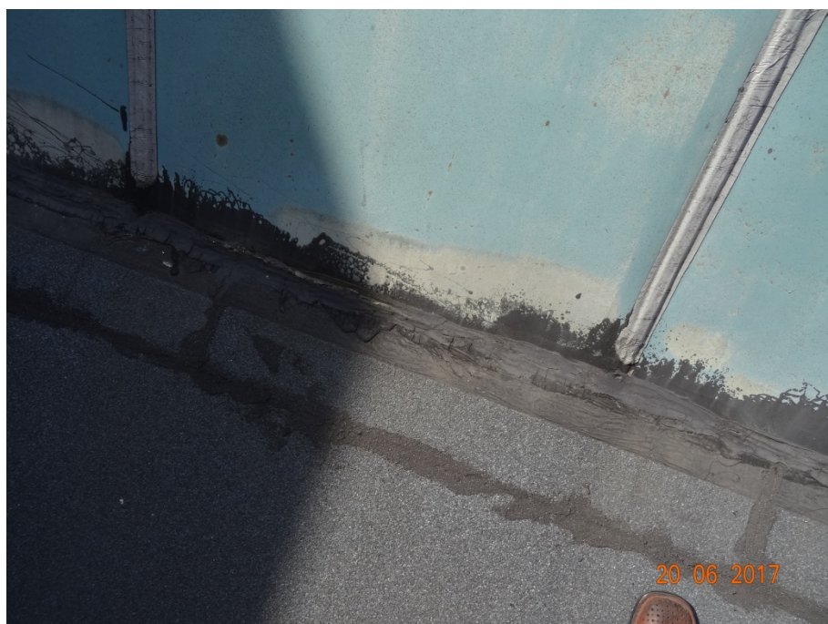
Fot. 38. Przykładowe odspojenia papy części płaskiej z blachą pokrywającą połacie skośne.
