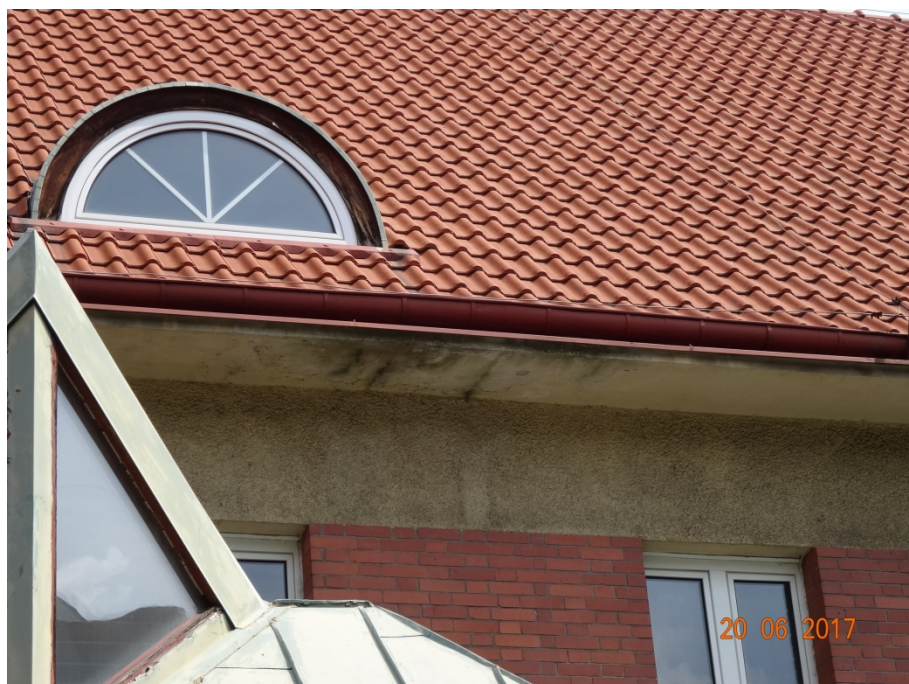
Fot. 19. Jak fot. 18, lecz zbliżenie na wadliwie zamocowany fragment rynny, pod którym widoczne są ślady zawilgoceń wodą opadową spływającą spod opierzenia blacharskiego.
