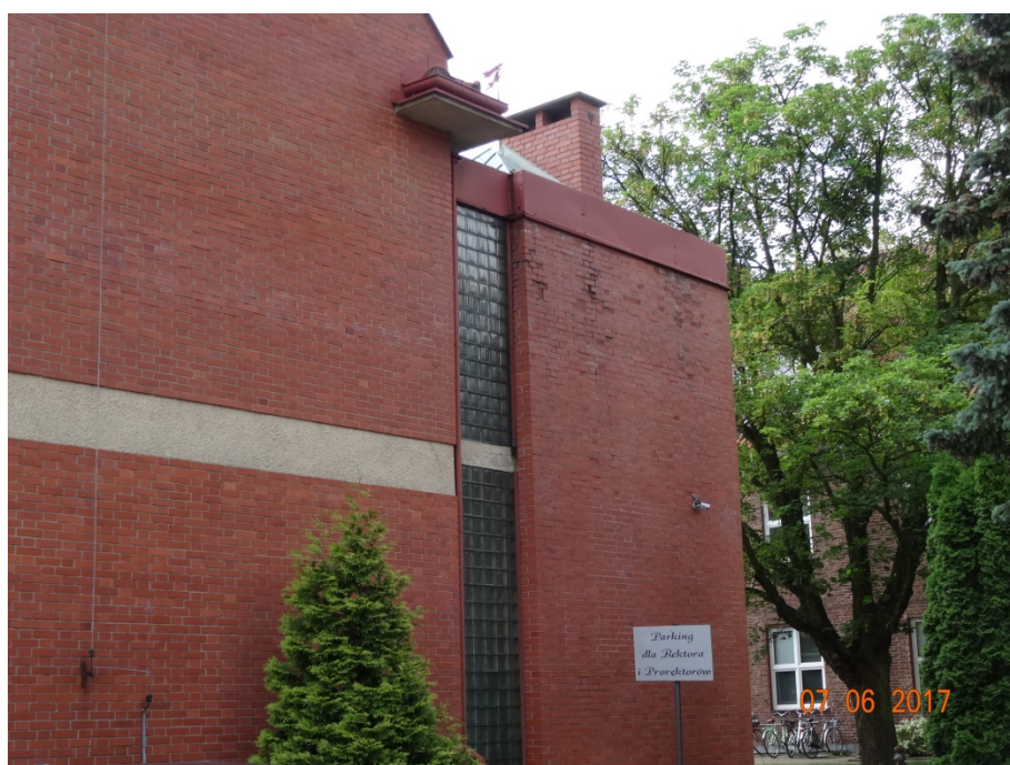
Fot. 10. Pn.-wsch. ściana szczytowa budynku zasadniczego i dwukondygnacyjnej części sanitarnej. Widoczne: wykwyty wapniowe na ścianie szczytowej spowodowane brakiem szczeliny wentylacyjnej ściany, złuszczenia cegły klinkierowej w górnej części dobudówki sanitarnej oraz zarysowania w poziomie wieńców.
