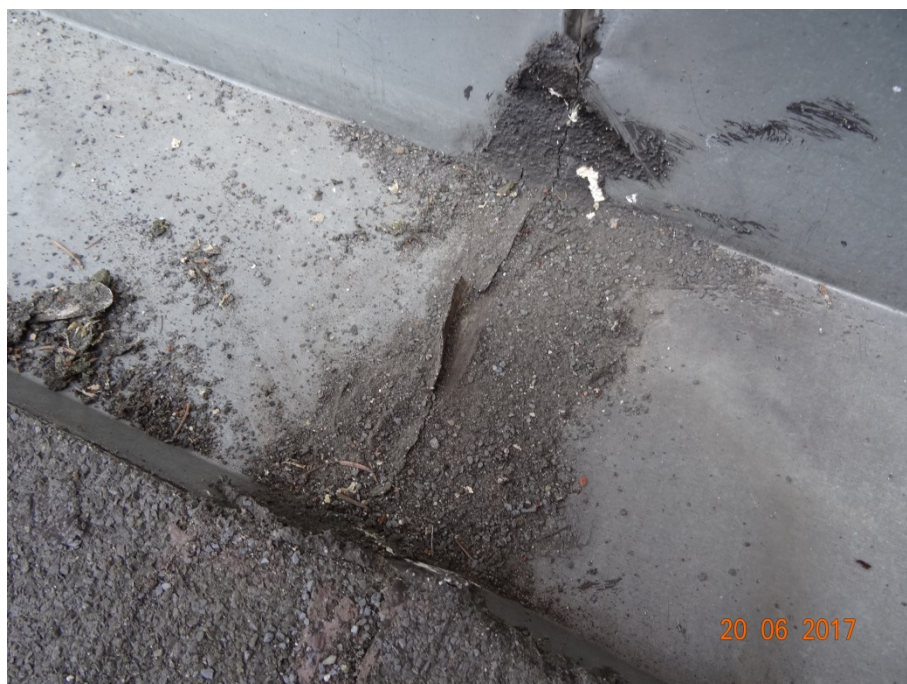
Fot. 40. Przykładowy stan realizowanych dotychczas uszczelnienia styków arkuszy blachy w korycie widocznego na fot. 39 po odgarnięciu zanieczyszczeń.
