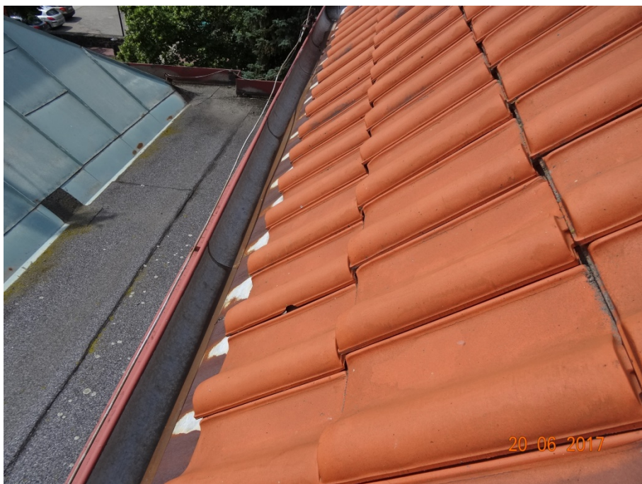
Fot. 29. Dach dwukondygnacyjnej części sanitarnej (fotografia wykonana przez okno na poddaszu użytkowym budynku zasadniczego). Ślady zastoisk wody przy ścianie budynku zasadniczego. Widoczne również uszczelnienia papowe blachy części ukośnej dachu oraz uszkodzenia korozyjne blachy oraz uszkodzenia korozyjne obróbki okapowej dachu budynku zasadniczego.
