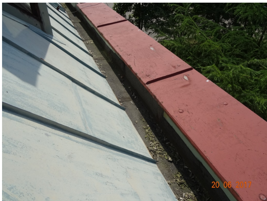
Fot. 33. Dach części parterowej. Koryto zewnętrzne uszczelnione papą. Widoczny pierwotny układ blach łączonych na rąbek stojący.
