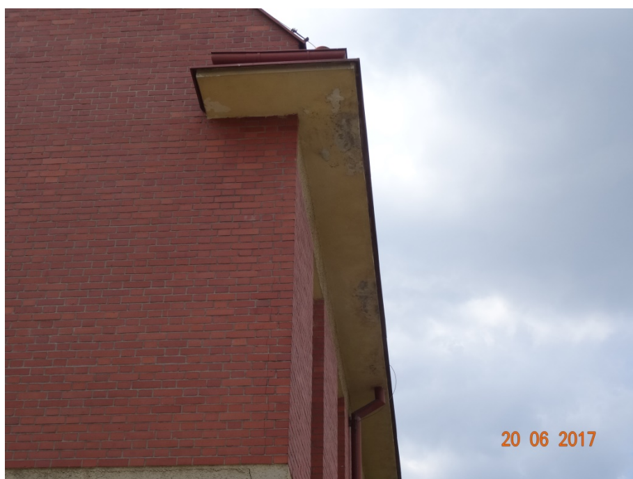
Fot. 12. Płd.-zach. ściana szczytowa. Zarysowanie pionowe warstwy fakturowej przy narożu budynku
