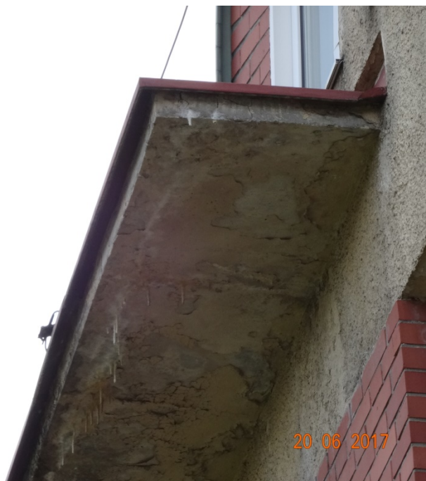
Fot. 5. Jak fot. 3 i 4, lecz zbliżenie na uszkodzony gzyms z naciekami wapiennymi w formie stalaktytów świadczącymi o występowaniu długotrwałych przecieków wody opadowej przez opierzenie blacharskie gzymsu.
