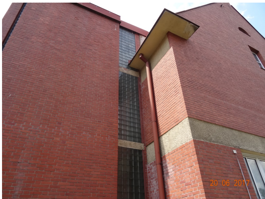
Fot. 51. Skrajna klatka schodowa. Ściana pld.-zach. Widoczne złuszczenia cegieł klinkierowych w górnej części ściany i powierzchniowe wykwyty solne oraz ubytek tynku w między górnymi pasami przeszklonymi luksferami.
