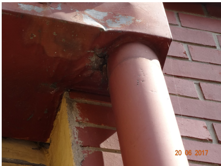
Fot. 32. Jak fot. 31, lecz zbliżenie na dziurę w dnie naczynia zbiorczego przy rurze spustowej.
