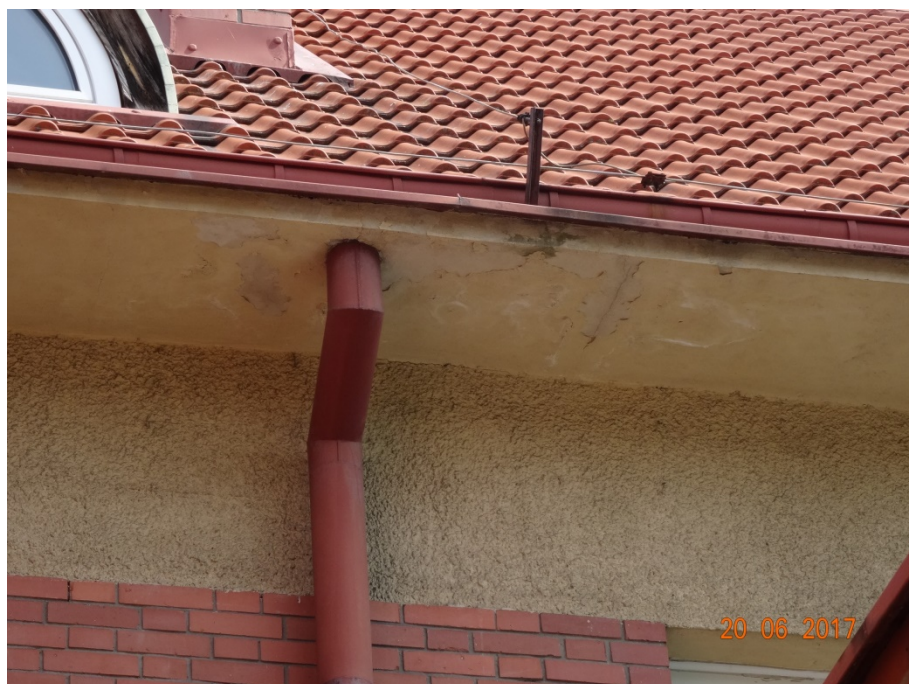
Fot. 17. Jak fot. 16, lecz zbliżenie. Widoczne ślady korozji opierzenia.
