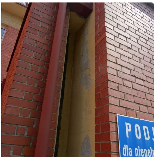
Fot. 30. Część parterowa od strony pn.-wsch. Uszkodzenia tynku spowodowane długotrwałym zawilgoceniem wodą opadową spływającą z dziurawego naczynia zbiorczego.
