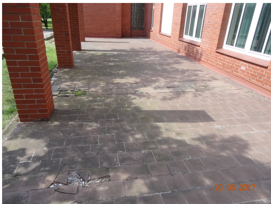
Fot. 46. Taras pomiędzy klatkami schodowymi. Zniszczenia posadzki z płytek ceramicznych.
