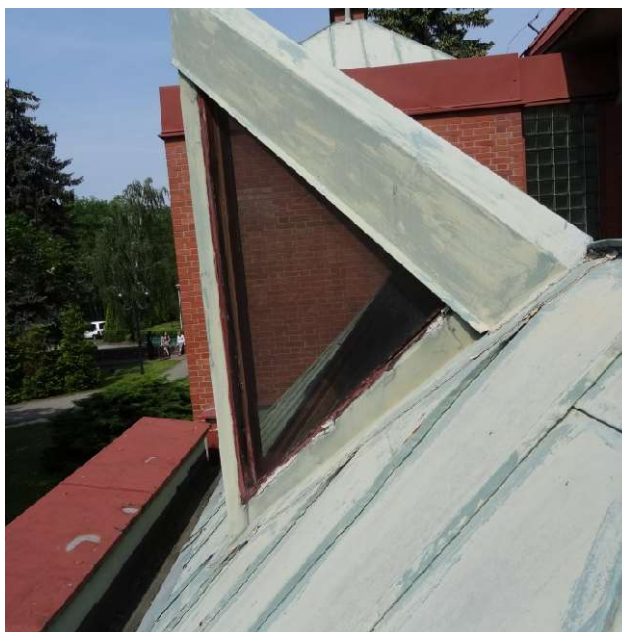
Fot. 41. Dach parterowej części obiektu. Naświetle trójkątne. Widoczne ślady wielokrotnego uszczelniania okna kitami.
