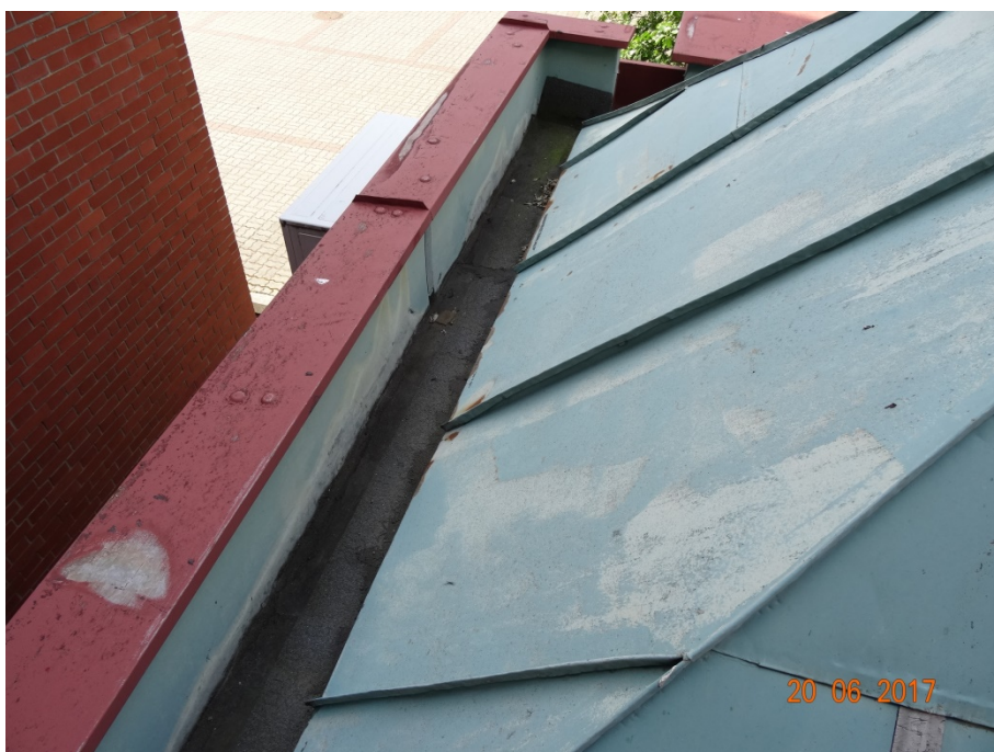
Fot. 36. Dach części parterowej obiektu. Koryto od strony środkowej klatki schodowej. Widoczne ślady zastoisk wody opadowej przy naczyniu zbiorczym. Widoczne również uszkodzenia korozyjne nie konserwowanej blachy.
