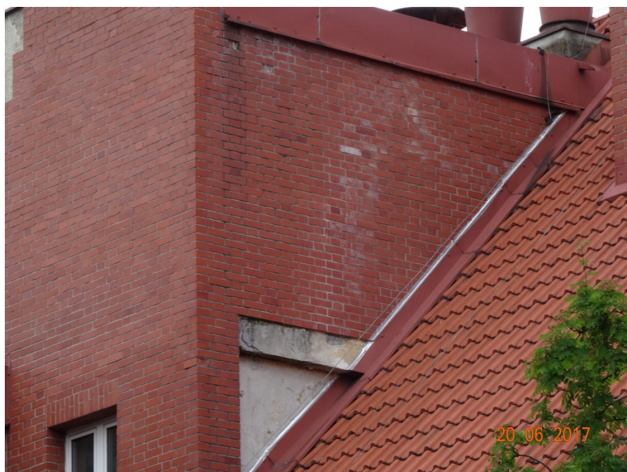
Fot. 20. Budynek zasadniczy. Płd.-zach. ściana boczna wystawki, w której znajduje się maszownia dźwigu towarowego. Widoczne: uszkodzenia cegły klinkierowej spowodowane wypływaniem wody opadowej spod opierzenia o blachy czołowe, powierzchniowe wykwity solne oraz uszkodzenia korozyjne wieńca oraz ściany znajdującej się pod nim.
