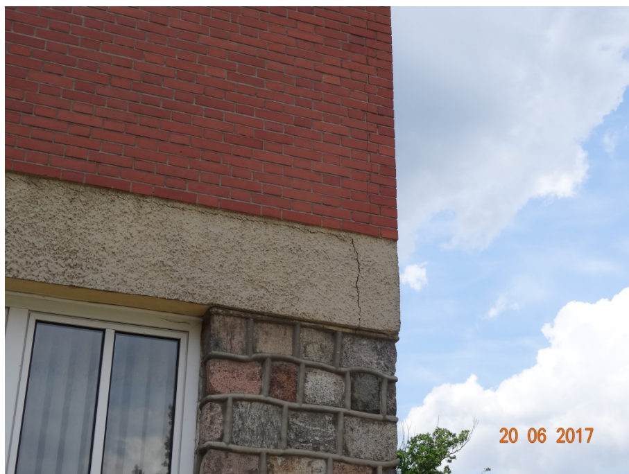
Fot. 13. Płd.-zach. ściana szczytowa. Zarysowanie poziome nad wieńcem stropowym przechodzące przy narożu budynku w zarysowanie pionowe. Widoczne również zarysowanie pokazane na fot. 12.
