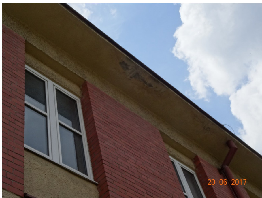
Fot. 7 i 8. Ściana frontowa. Przykładowe uszkodzenia płyty gzymsowej spowodowane przeciekami wody opadowej przez nieszczelności opierzenia blacharskiego,
