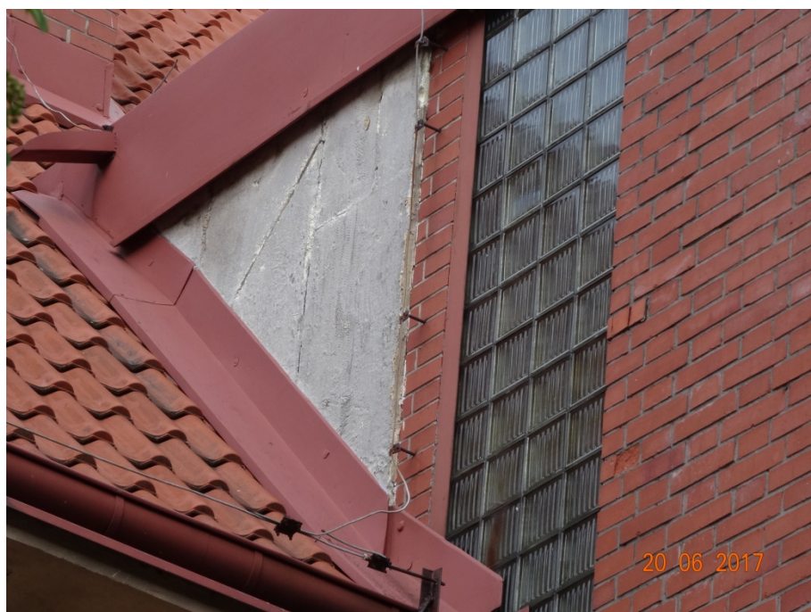
Fot. 54. Jak. fot. 53, lecz zbliżenie na uszkodzenia trójkątnej ściany przy połączeniu budynku zasadniczego.
