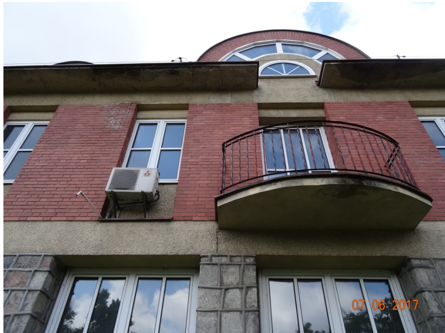
Fot. 3. Część środkowa ściany frontowej. Zarysowanie pionowe klinkierowej warstwy osłownej przebiegające w górę od dylatacji rygla i przechodzące w dół na górnych warstwach granitowego filara międzyokiennego. Widoczne również uszkodzenia dolnej powierzchni płyt gzymsowych i płyty balkonowej.
