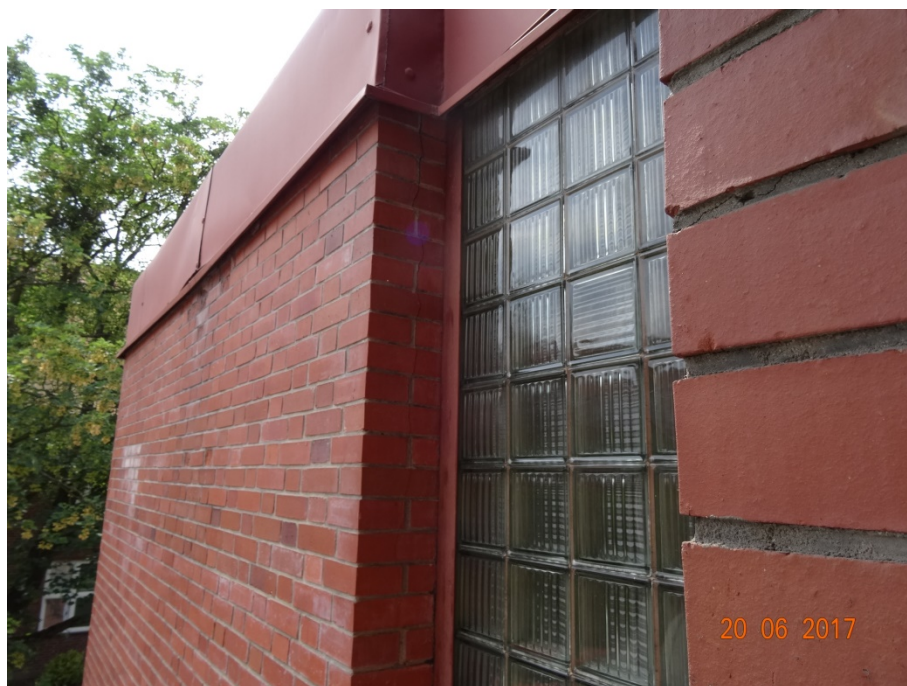
Fot. 24. Ściana płd.-zach. dwukondygnacyjnej części sanitarnej. Złuszczenia cegły klinkierowej spowodowane długotrwałym zawilgoceniem wodą opadową spływającą spod opierzenia i blachy czołowej. Widoczne również powierzchniowe wykwity solne.
