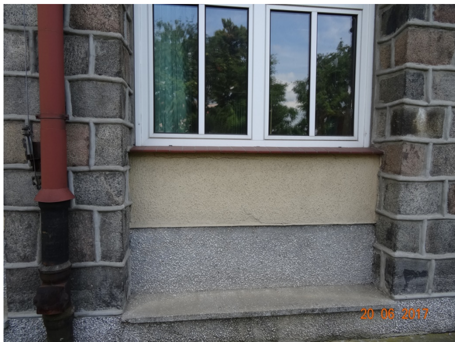
Fot. 9. Ściana frontowa. Przykładowe zarysowania poziome podokienników.
