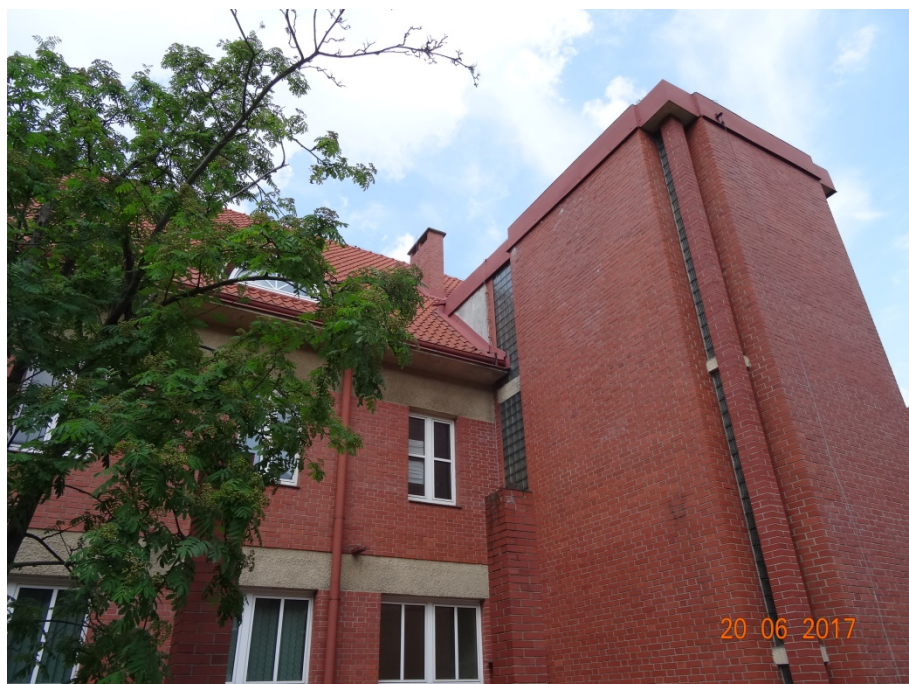
Fot. 53. Skrajna klatka schodowa. Ściana pn.-wsch. Widoczne ślady zawilgoceń, złuszczenia cegieł oraz powierzchniowe wykwyty solne.
