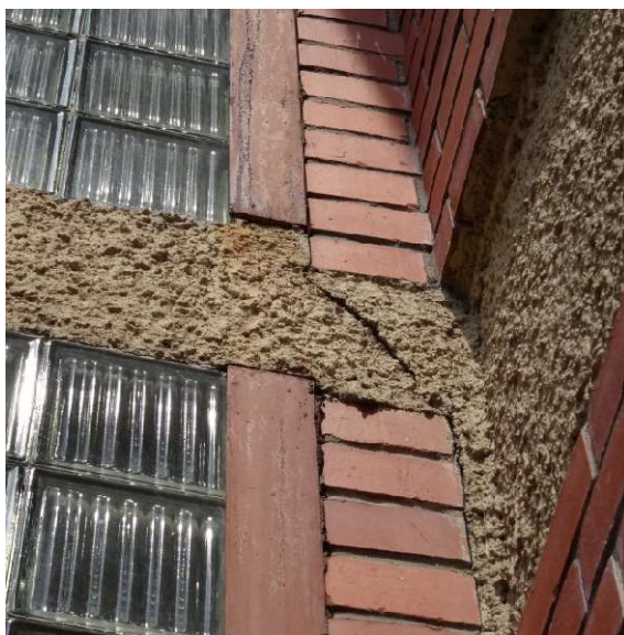
Fot. 27 Jak fot. 26, lecz zbliżenie na zarysowanie. Widoczne również ślady korozji ceowników mocujących ściankę z luksferów.
