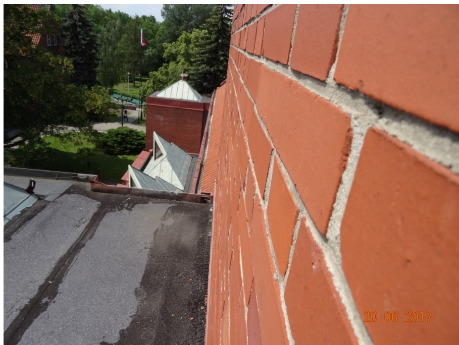
Fot. 45. Dach środkowej klatki schodowej (fotografia wykonana z okna wystawki na dachu budynku zasadniczego). Płaski fragment dachu przy budynku zasadniczym kryty papą na pierwotnym pokryciu blaszanym. Widoczny brak wywinięcia papy na opierzenie skutkujący przeciekami pokazanymi na fot. .... W głębi widoczne dachy części parterowej i sanitarnej obiektu.
