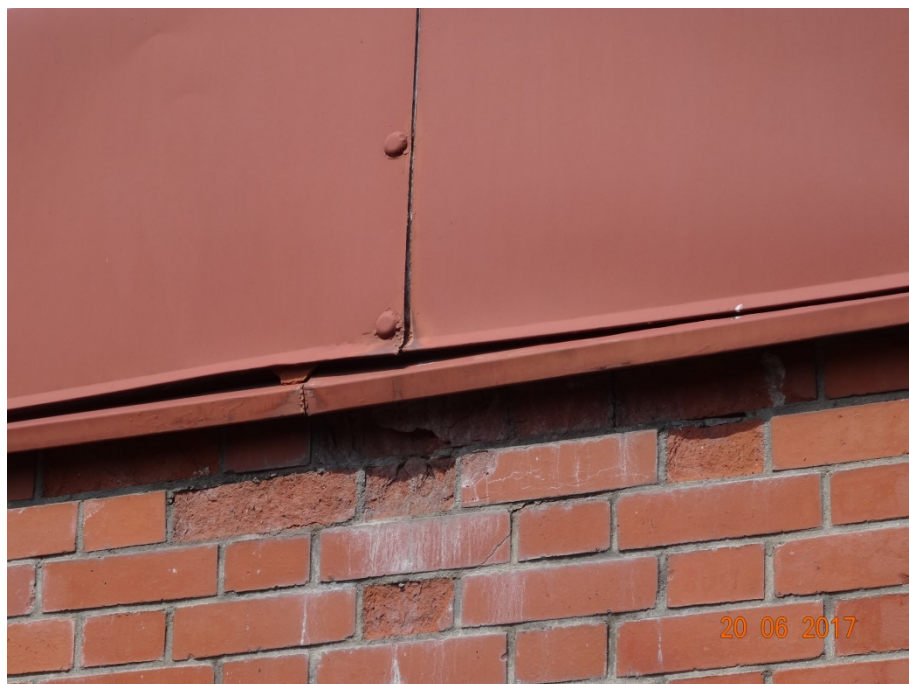
Fot. 25. Jak fot. 24, lecz zbliżenie na złuszczenia cegły klinkierowej pod wadliwie wykonanymi opierzeniem blacharskim i blachą czołową.
