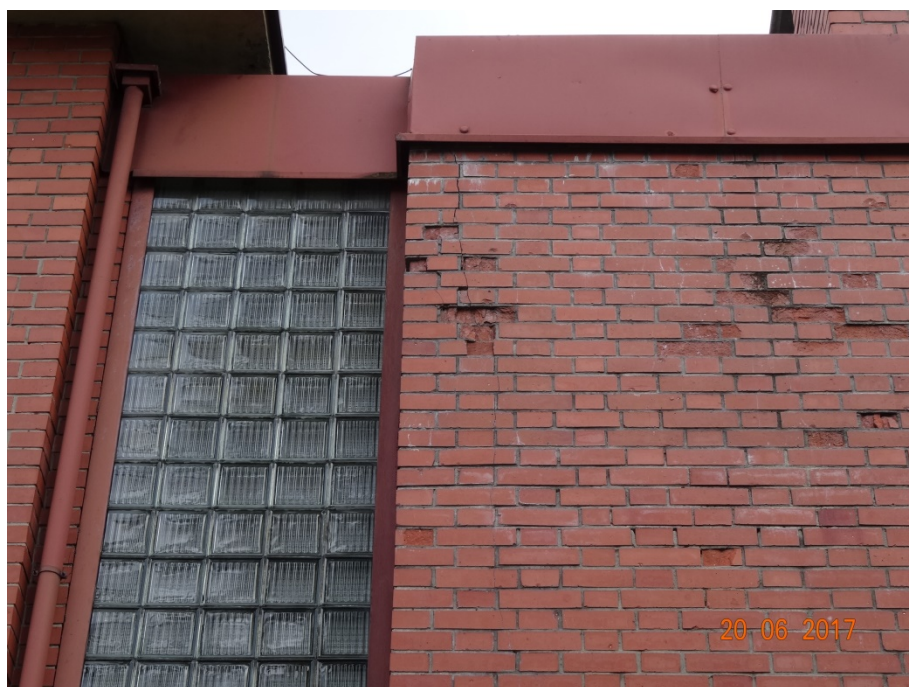
Fot. 22. Jak fot. 21, lecz zbliżenie na zarysowanie warstwy fakturowej ściany.
