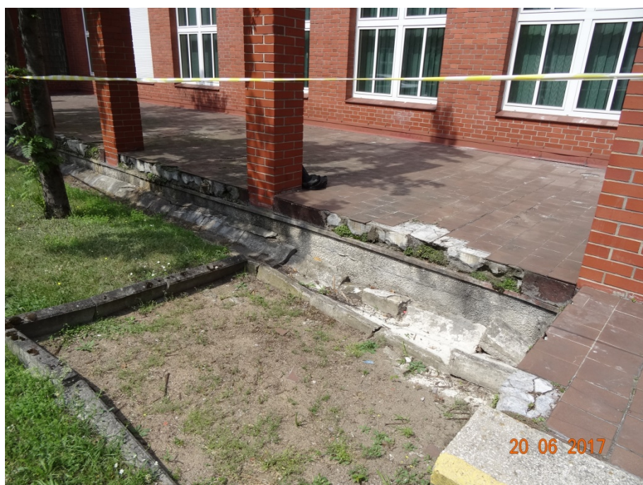
Fot. 48. Taras. Zniszczenia powierzchni czołowej i betonowego koryta odwadniającego teren.
