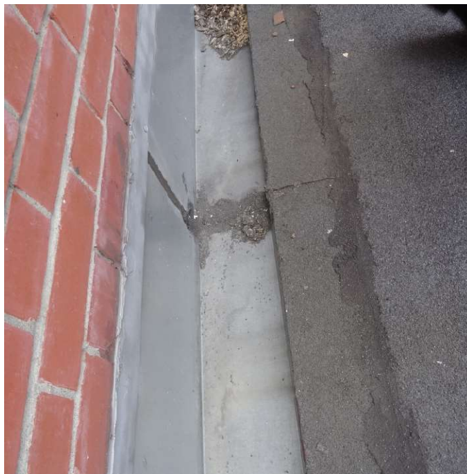
Fot. 39. Koryta przy ścianie budynku zasadniczego. Oprócz zanieczyszczeń widoczne uszczelnione paskami papy lub kitem bitumicznym styki arkuszy blachy.
