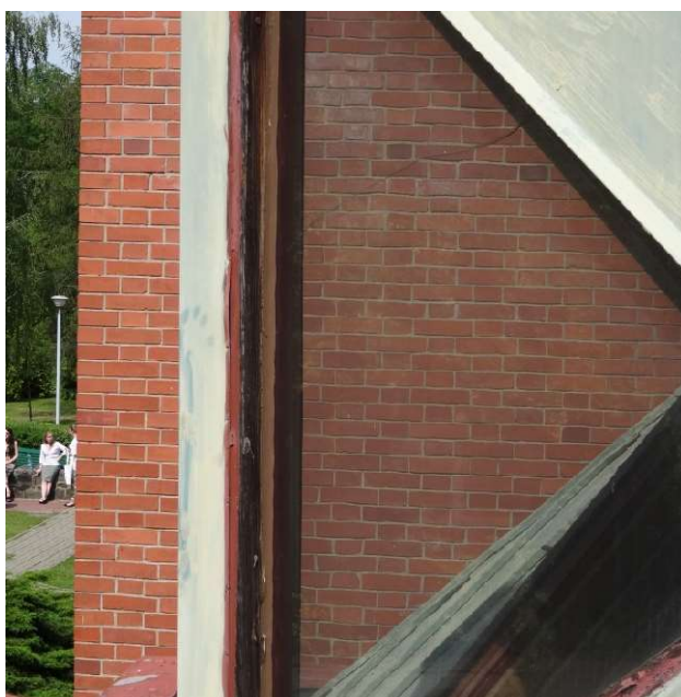
Fot. 42. Jak fot. 41, lecz zbliżenie na skorodowaną listwę pionową.
