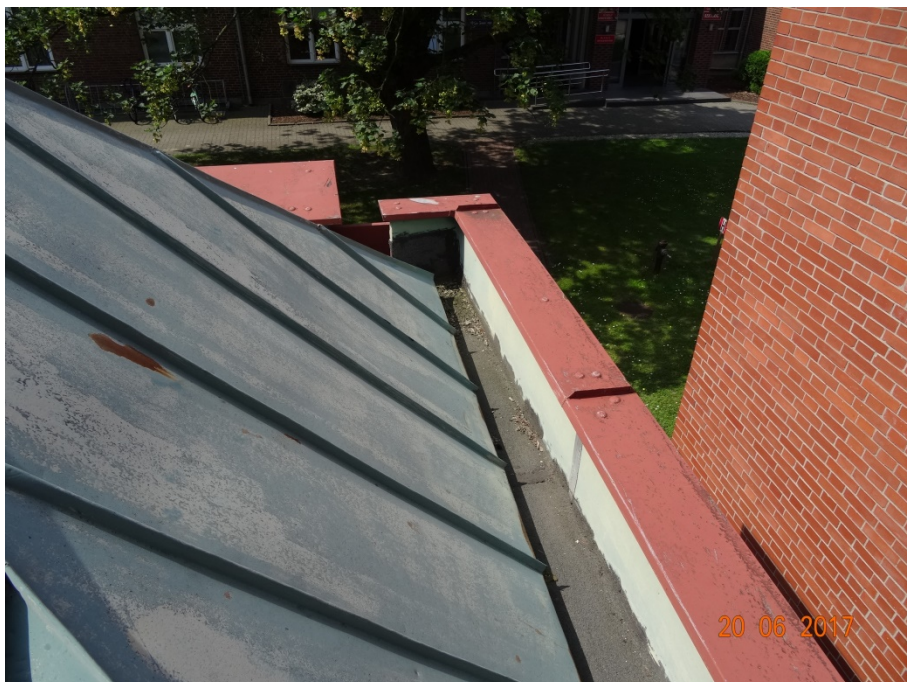
Fot. 35. Dach części parterowej. Koryto od strony pn.-wsch. Widoczne ślady zastoisk wody opadowej przy naczyniu zbiorczym oraz zalegające w tam zanieczyszczenia.
