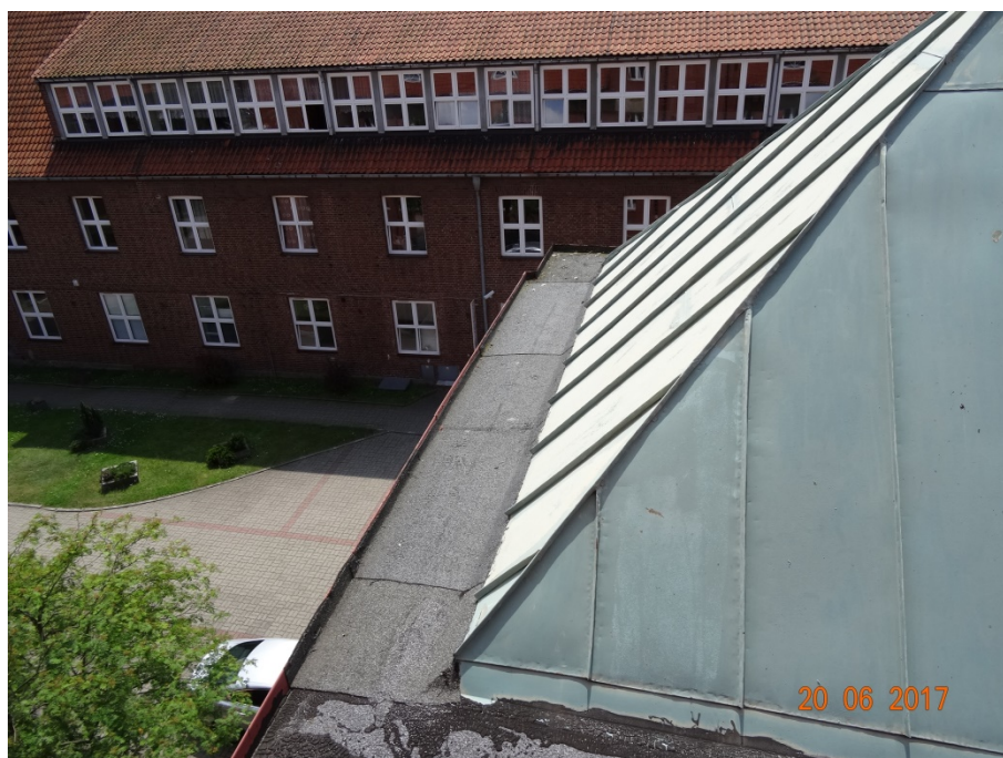
Fot. 44. Dach środkowej klatki schodowej (fotografia wykonana z okna wystawki na dachu budynku zasadniczego). Rozwiązania i wady identyczne jak w przypadku dachu części sanitarnej obiektu.
