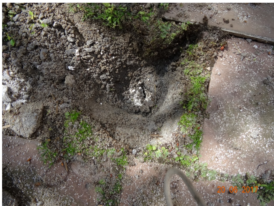
Fot. 50. Taras odkrywka identyfikująca warstwową budowę tarasu. Pod płytkami znajduje się 8 cm warstwa bardzo słabego betonu i 8 cm warstwa styropianu ułożonego na papie. Rozwiązanie niezgodne z ustaleniami dokumentacji projektowej/
