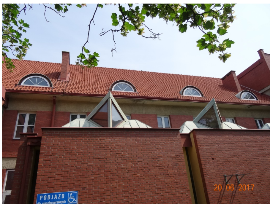
Fot. 18. Ściana tylna budynku zasadniczego. Uszkodzenia płyty gzymsu. Wadliwie zamocowana rynna, która jest nachylona w stronę budynku.
