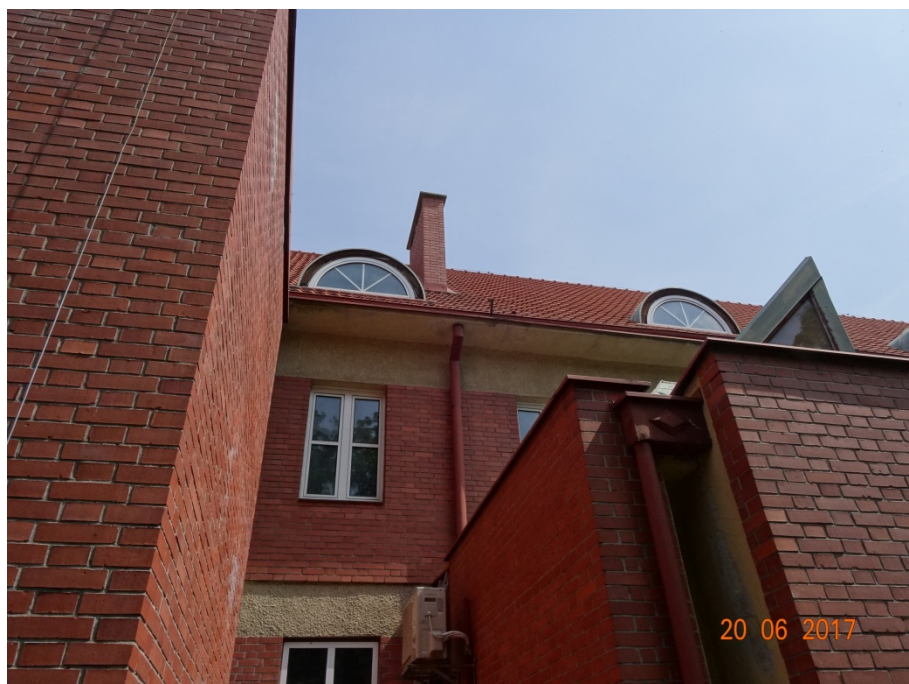
Fot. 16. Ściana tylna budynku. Przykładowe uszkodzenia płyty gzymsowej spowodowane przeciekami przez nieszczelne rynny lub opierzenie blacharskie gzymsu
