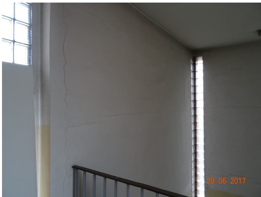
Fot. 113. Zarysowania płd.-zach. ściany bocznej w poziomie wejścia na poddasze użytkowe.
