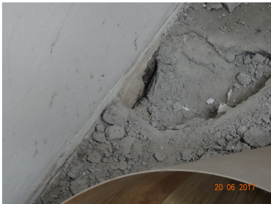
Fot. 72. Odkrywka przy nie zawilgoconym fragmencie ściany wewnętrznej. Widoczne wywiniecie nowej izolacji na otynkowaną ścianę. Ponadto w posadzce stwierdzono nieprzewidywany w dokumentacji projektowej styropian.
