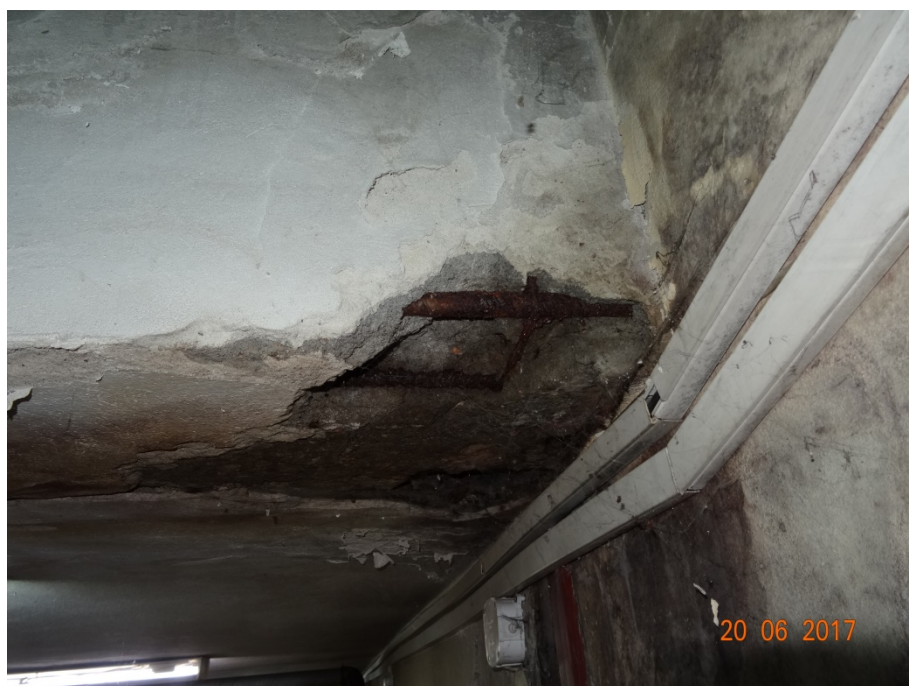
Fot. 60. Zniszczenia żelbetowego podciągu w osi ściany tylnej budynku – ubytek otuliny, korozja prętów zbrojeniowych.
