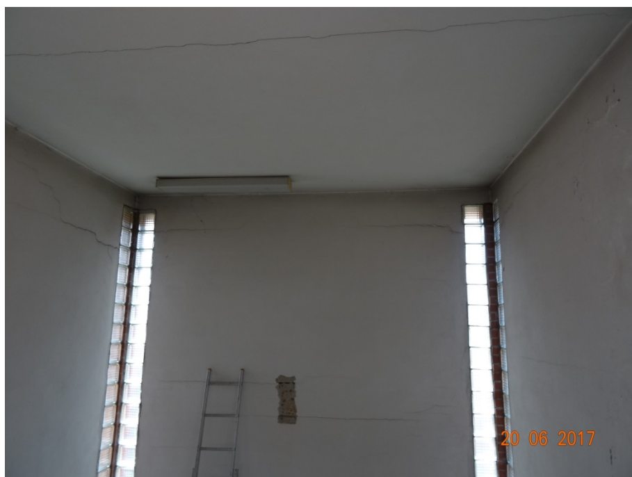
Fot. 133. Widok ogólny stanu zarysowań górnych fragmentów ścian skrajnej klatki schodowej i stropu.
