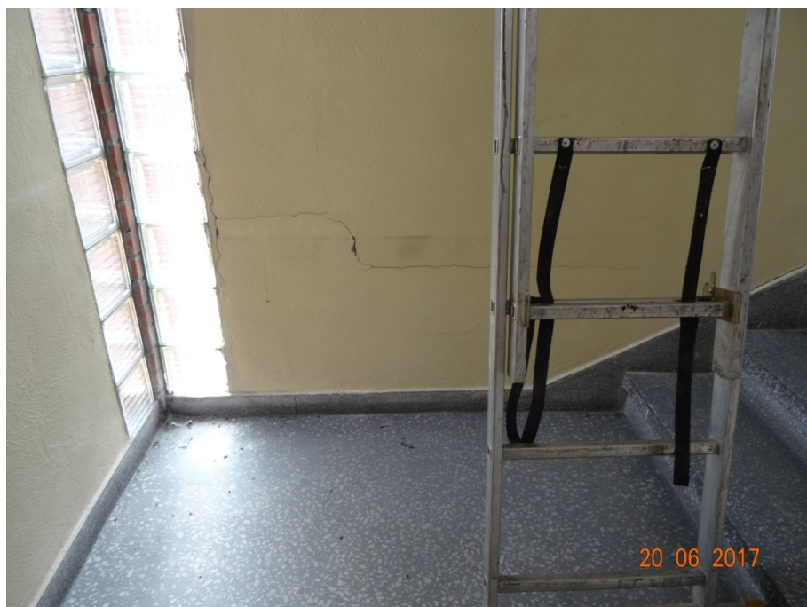
Fot. 132. Rysa pozioma nad pierwszy spocznikiem biegu pomiędzy piętrem i poddaszem użytkowym.
