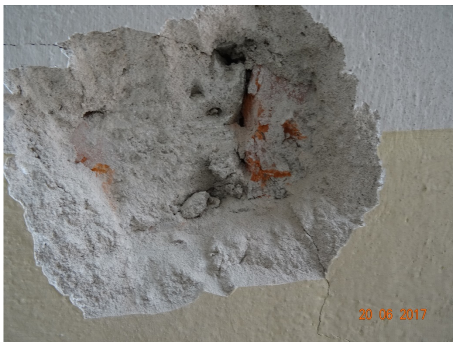
Fot. 123. Odkrywka prawa jak na fot. 121. Rysa pozioma przebiega w spoinie poziomej mury natomiast rysa pionowa w materiale ceramicznym przy bardzo szerokiej spoinie pionowej.
