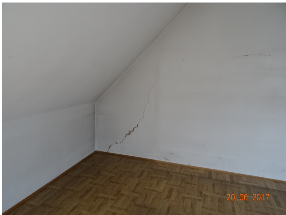
Fot. 79. Zarysowanie ukośne pn.-zach. ściany szczytowej przy ścianie tylnej budynku zasadniczego.
