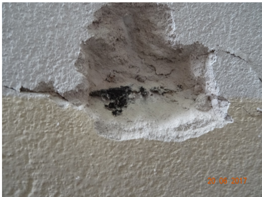
Fot. 118. Odkrywka rysy jak na fot. 117. Rysa przebiega nad izolacją poziomą ściany.
