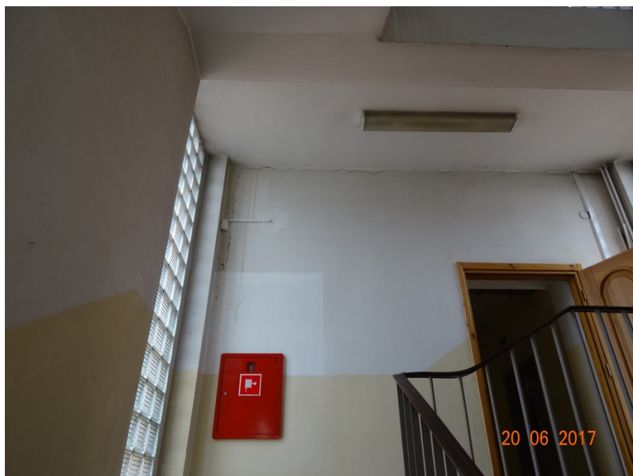
Fot. 103. Zarysowanie rozdzielcze w poziomie stropu parteru.
