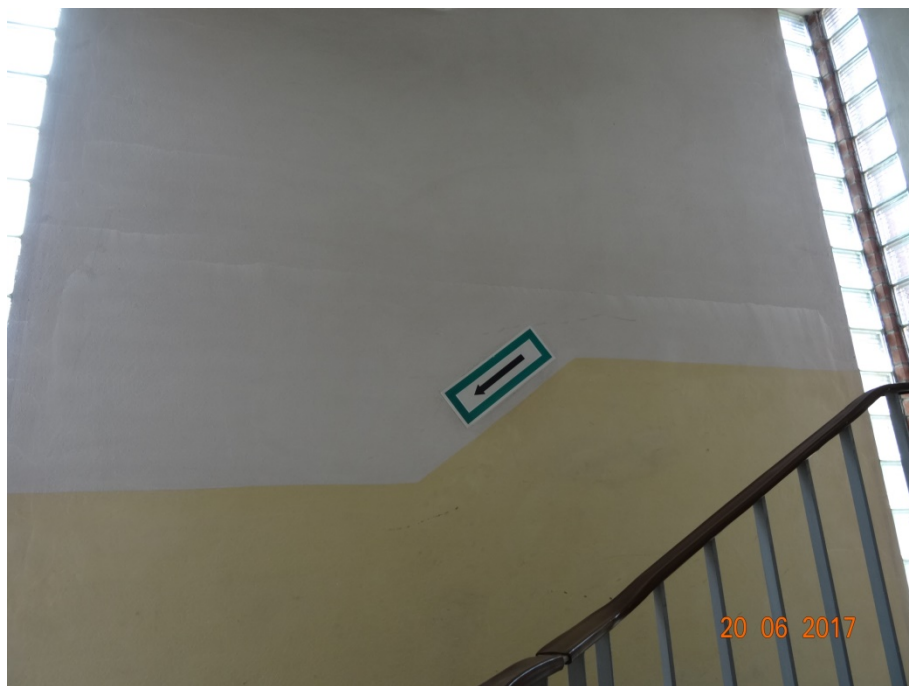
Fot. 106. Zarysowanie poziome ściany tylnej między partem i piętrem.
