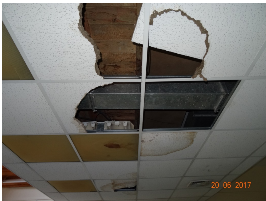
Fot. 101. Ślady przecieków wody opadowej przez płaski fragment dachu.
