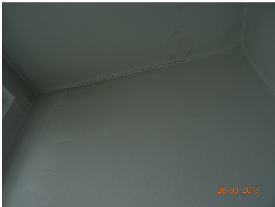
Fot. 94. Zarysowanie rozdzielcze w styku strop nad piętrem – ściana. Widoczne również ślady przecieków wody opadowej przez dach.
