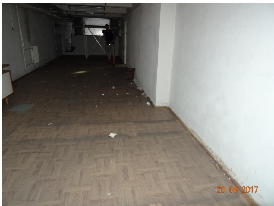
Fot. 69. Przykładowe zawilgocenie przypodłogowych fragmentów wewnętrznej ściany piwnicznej.
