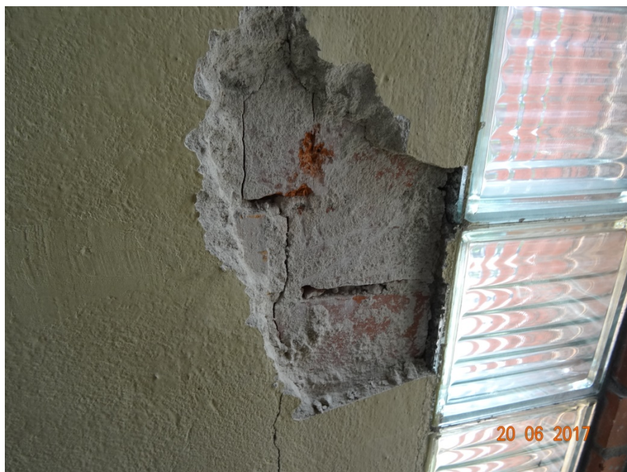
Fot. 120. Jak fot. 119, lecz zbliżenie na odkrywkę. Rysa przebiega przez materiał ceramiczny warstwy konstrukcyjnej ściany.
