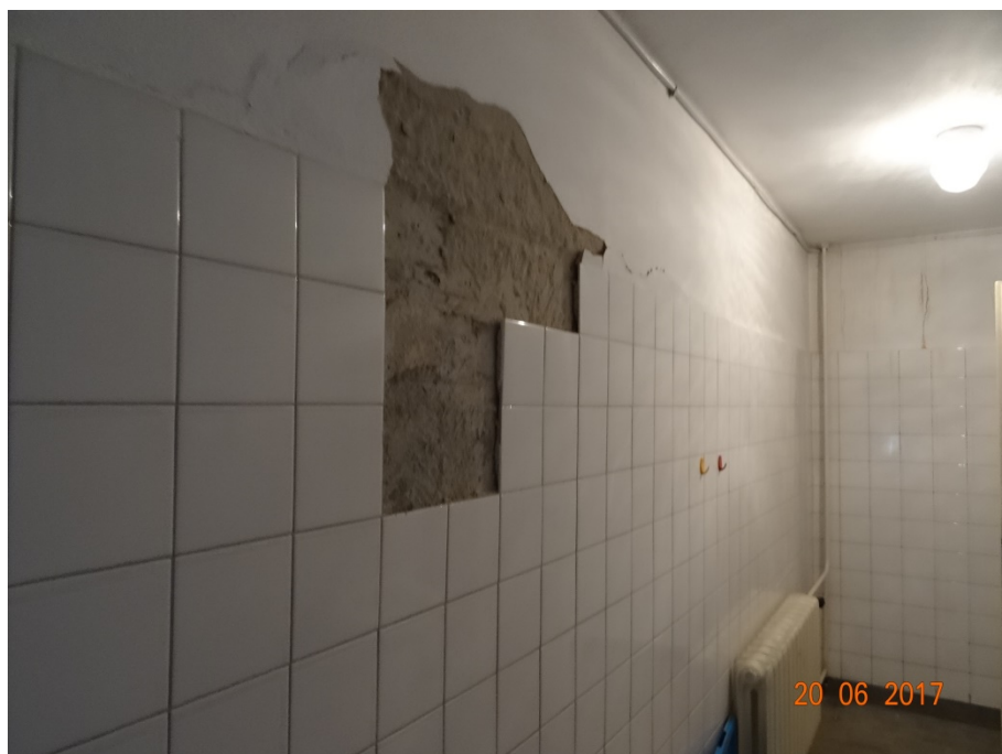
Fot. 97. Sanitariaty w piwnicy. Ubytki płytek ceramicznych
