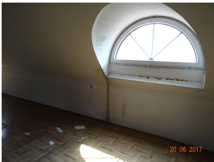
Fot. 81. Przykładowe ślady zawilgocień obudowy lukarny połaci tylnej i ścianki kolankowej wskazujące na nieszczelności pokrycia dachowego.
