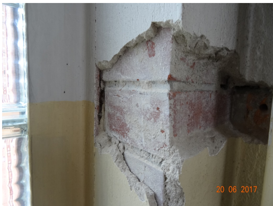
Fot. 131. Odkrywka rysy pionowej widocznej na fot. 129. Rysa przebiega wzdłuż półki kształtownika stalowego.
