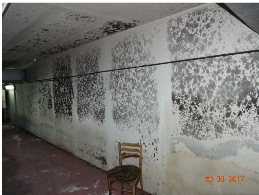
Fot. 61. Wentylatornia. Porażenie przez grzyby pleśniowe płyt gipsowo-kartonowych pokrywających strop i ściany pomieszczenia.
