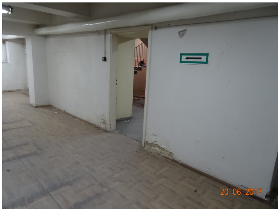
Fot. 68. Przykładowe zawilgocenie nadposadzkowych fragmentów wewnętrznych ścian piwnicznych.
