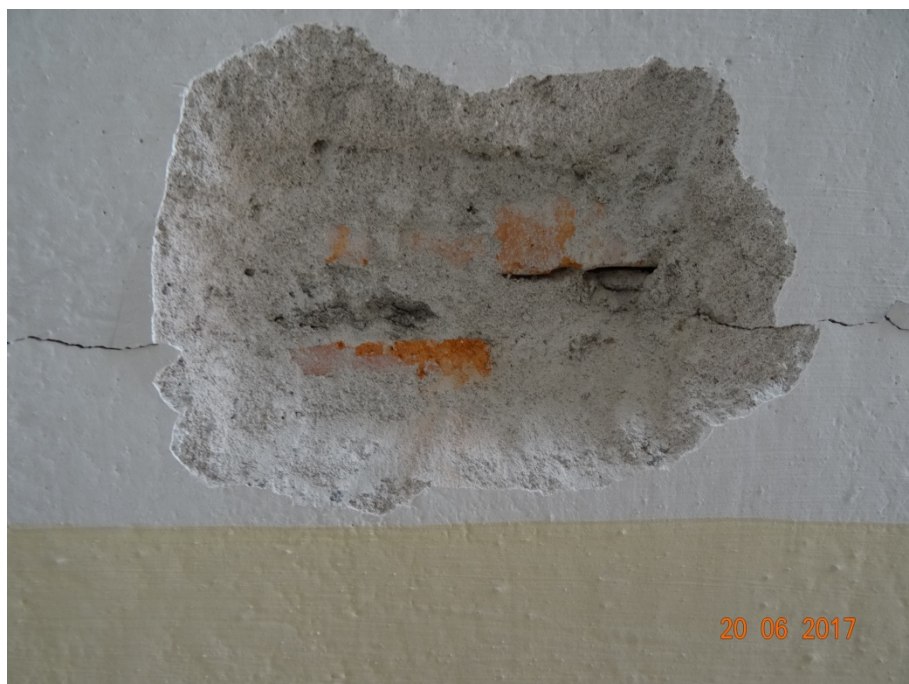
Fot. 122. Odkrywka lewa jak na fot. 121. Rysa przebiega przez spoinę poziomą muru.
