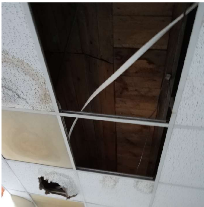
Fot. 100. Ślady przecieków wody opadowej przez płaski fragment dachu.
