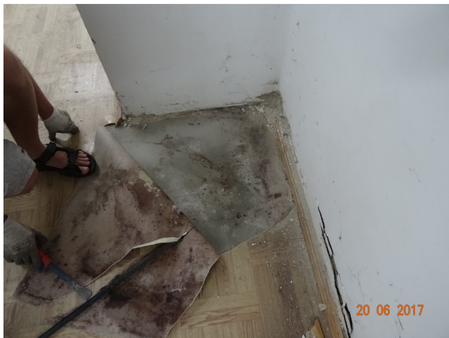
Fot. 70. Odkrywka przy uskoku ściany pokazanym na fot. 69. Po odgięciu tworzywowej wykładziny pcw na powierzchni podkładu widoczne są ślady porażenia przez grzyby pleśniowe.
