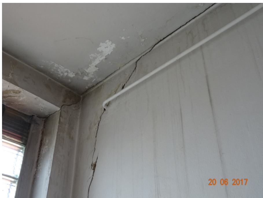
Fot. 115. Jak fot. 114, lecz zbliżenie na zarysowane i zawilgocone naroże. Widoczne zarysowanie rozdzielcze między stropem, a ścianą budynku zasadniczego.
