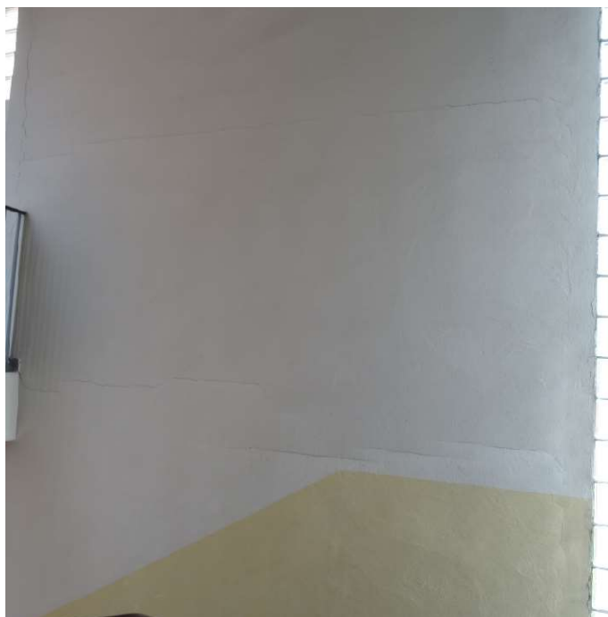
Fot. 110. Zarysowania ściany płd.-wsch. w poziomie najwyższego spocznika.
