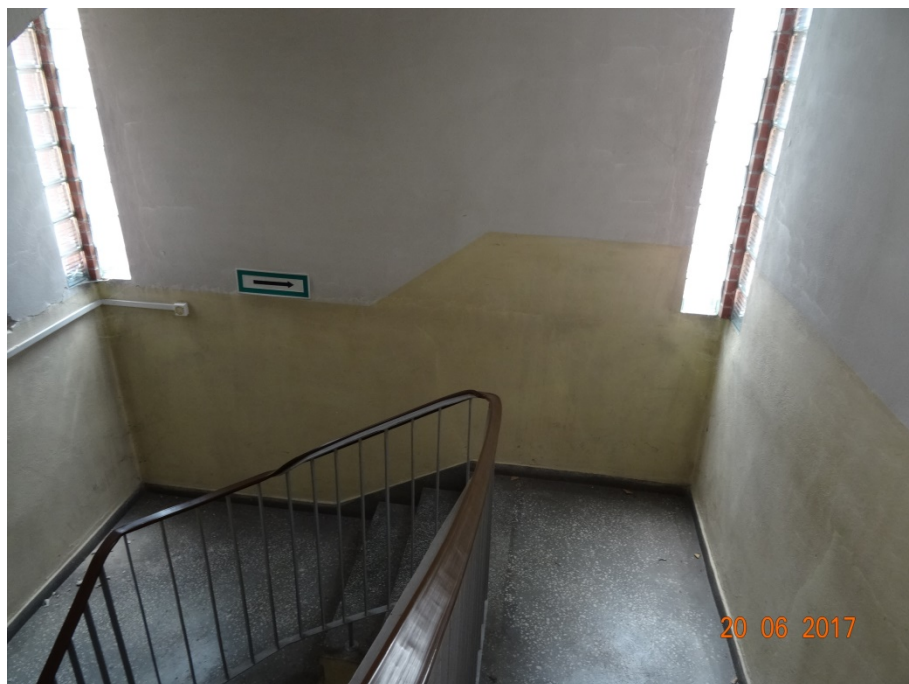
Fot. 104. Zarysowanie poziome ściany tylnej w poziomie dołu naświetli z luksferów.
