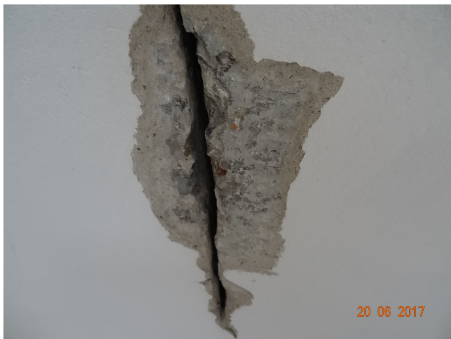
Fot. 84. Jak fot. 83, lecz zbliżenie. Styk płyt bez jakiegokolwiek wypełnienia.
