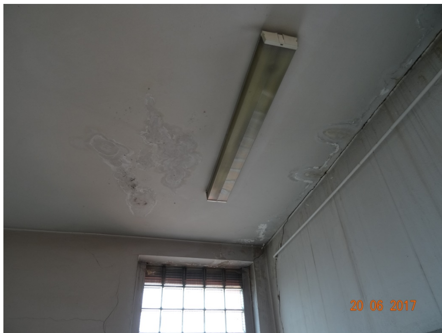
Fot. 114. Zarysowania w styku klatki schodowej ze ścianą budynku zasadniczego oraz zawilgocenia stropu klatki schodowej i
