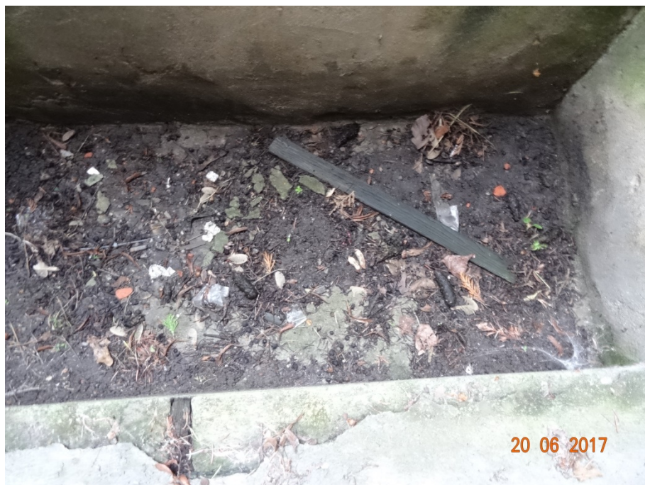
Fot. 74. Dno obudowy okien piwnicznych bez odwodnienia.
