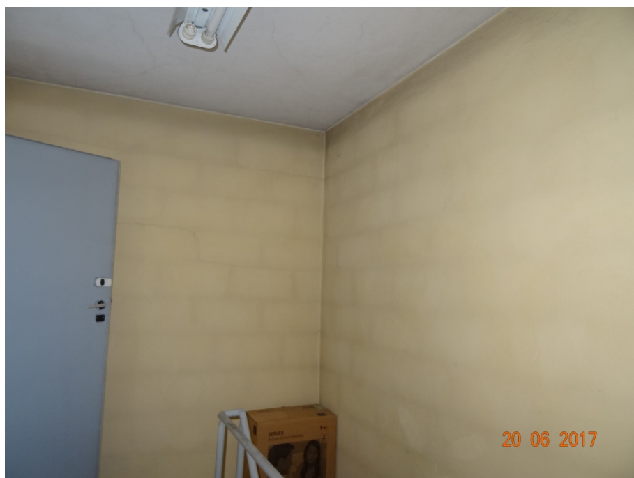
Fot. 89. Przykładowy stan zarysowań ścian wewnętrznej klatki schodowej prowadzącej na poddasze nieużytkowe.
