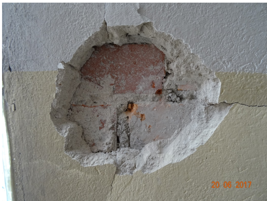
Fot. 126. Jak fot. 124, lecz zbliżenie na odkrywkę . Rysa pozioma przebiega w spoinie poziomej, natomiast rysa pionowa przez materiał ceramiczny i spoiny pionowe.
