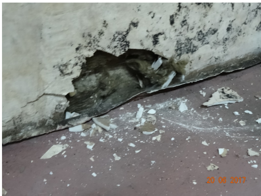
Fot. 63. Wentylatornia. Izolacja pozioma posadzki wywinięta na płyty gipsowo-kartonowe.
