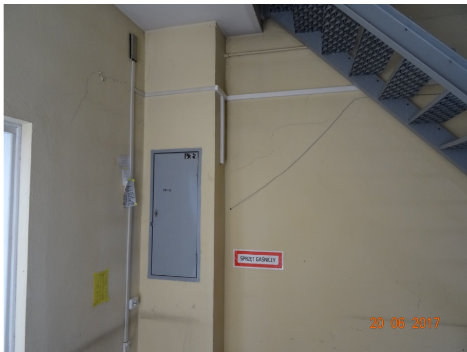
Fot. 88. Zarysowania ścian wewnętrznej klatki schodowej prowadzącej na poddasze nieużytkowe.
