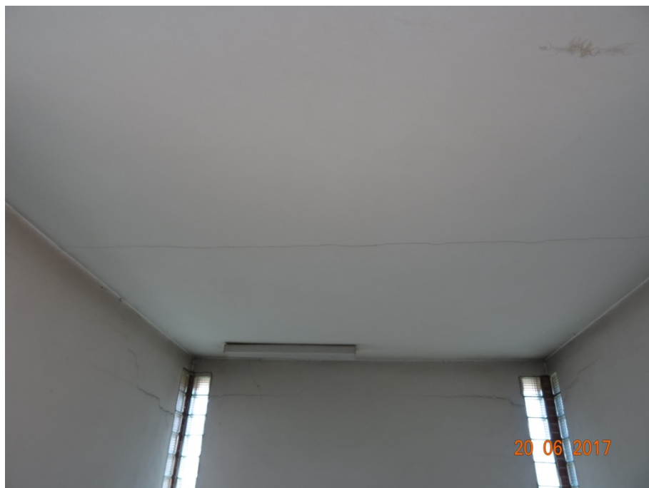
Fot. 140. Zarysowanie poprzeczne stropu w połowie długości skrajnej klatki schodowej.
