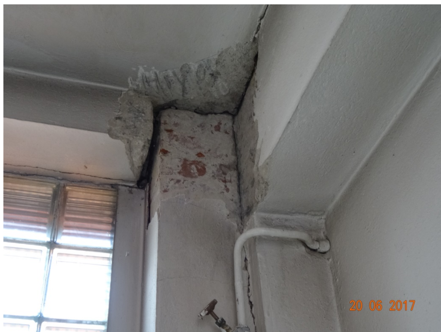
Fot. 139. Zrealizowane rozwiązanie konstrukcyjne naroża przy ścianie budynku zasadniczego widoczne w istniejącej odkrywce. Nadproże bez oparcia, skrajny słupek ceglany nie powiązany ze ścianą i płytą stopową.
