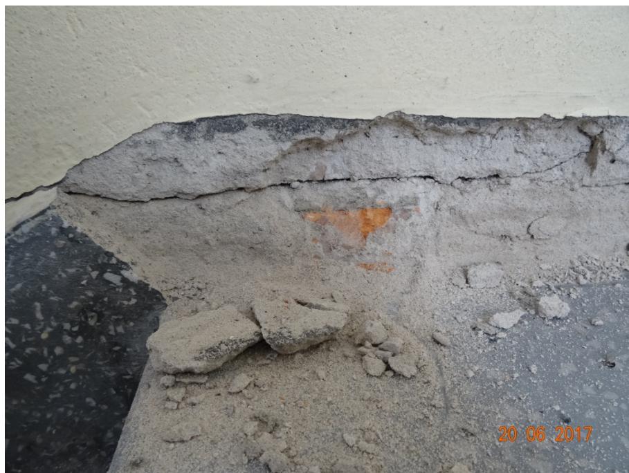
Fot. 128. Odkrywka nad spocznikiem. Rysa przebiega w spoinie poziomej muru o nadmiernej grubości.
