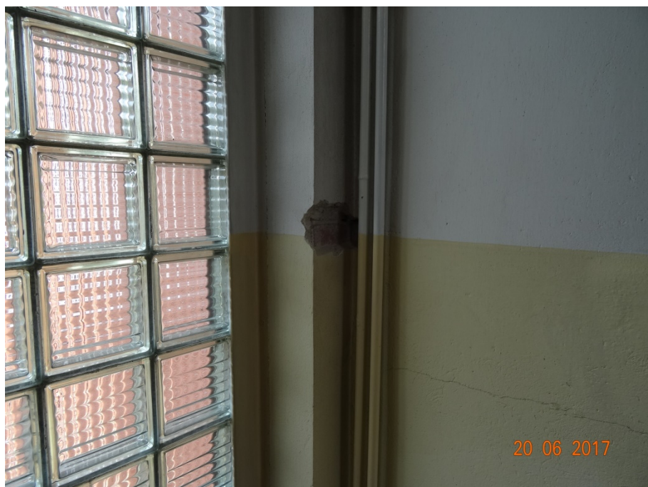
Fot. 129. Odkrywka skrajnego filarka przy ścianie budynku zasadniczego. Widoczna również rysa pozioma przebiegająca od spocznika w poziomie piętra oraz rysa pionowa przy uzupełnieniu ściany przy luksferach.
