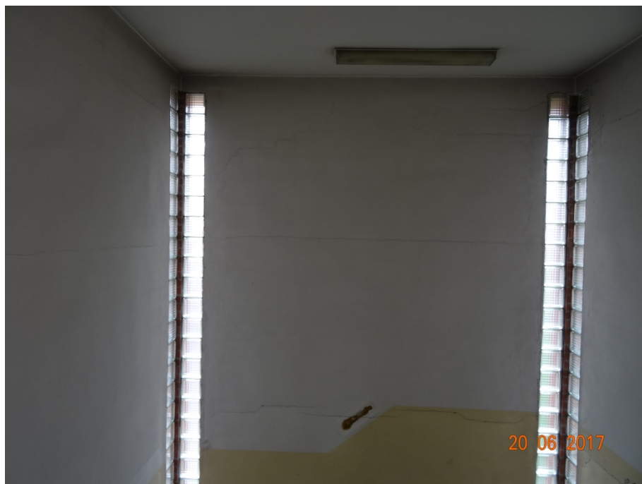
Fot. 112. Stan zarysowań górnych fragmentów ścian środkowej klatki schodowej.
