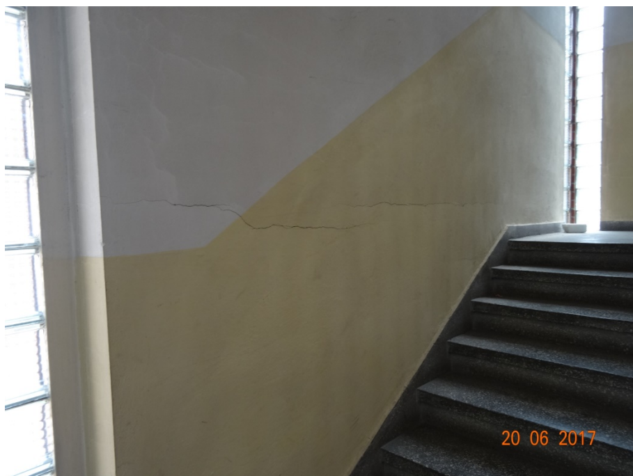
Fot. 105. Zarysowanie ściany pn.-zach. nad drugim spocznikiem między parterem i piętrem.
