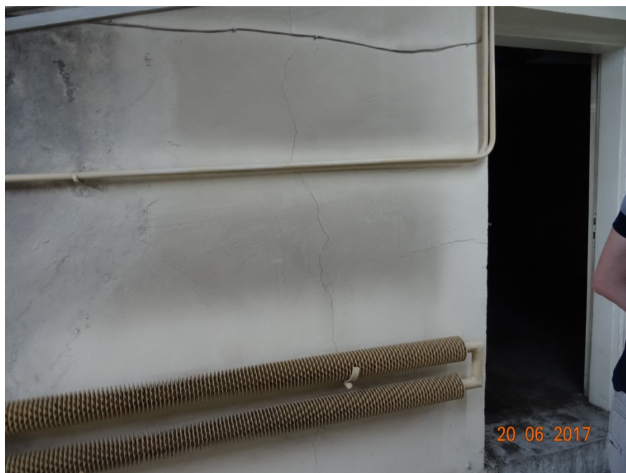
Fot. 56. Zarysowanie pionowe poprzecznej ściany oddzielającej dojście do tunelu od wentylatorni przebiegające na pograniczu ściany podłużnej w wentylatorni.
