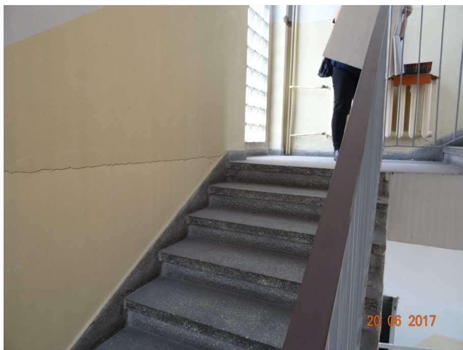
Fot. 127. Rysa pozioma jak na fot. 123 przebiega nad trzecim spocznikiem pomiędzy parterem i piętrem.
