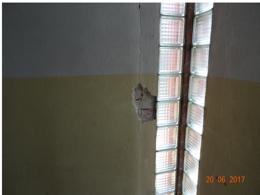
Fot. 119. Skrajna Klatka schodowa. Zarysowanie pionowe ściany przy naświetlu z luksferów na pierwszym spoczniku między parterem i piętrem.
