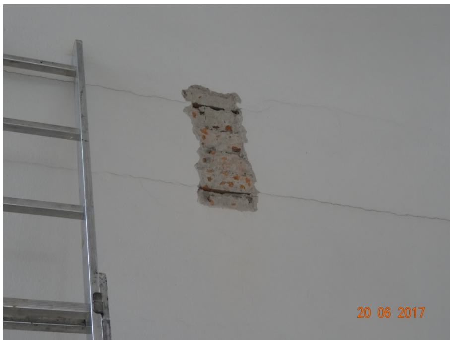
Fot. 134. Jak fot. 133, lecz zbliżenie na istniejącą odkrywkę. Obie rysy przebiegają w spoinach poziomych wydzielając pasmo o wysokości czterech warstw cegieł.
