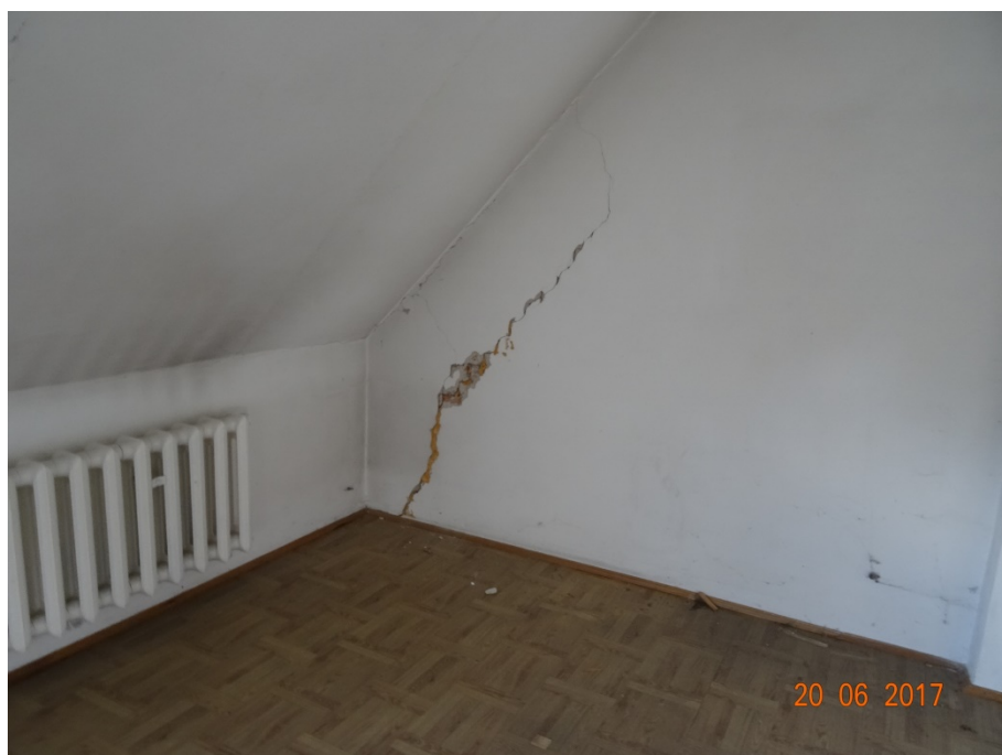
Fot. 77. Zarysowania płd.-wsch. ściany szczytowej przy ścianie frontowej.
