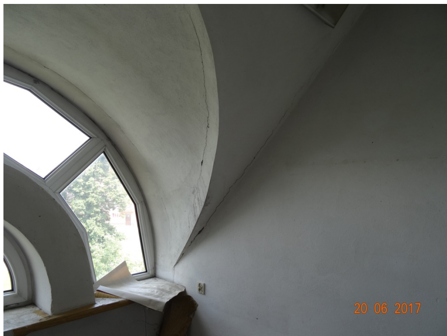
Fot. 86. Zarysowania obudowy lukarny przy dylatacji spowodowane nie przeniesienia dylatacji na elementy wykończeniowe.
