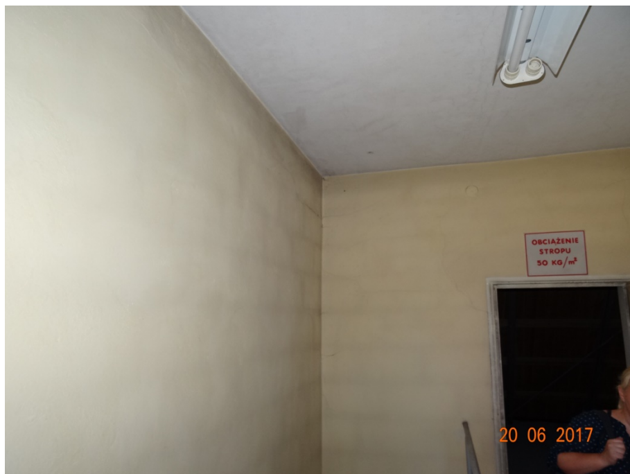
Fot. 90. Przykładowy stan zarysowań ścian wewnętrznej klatki schodowej prowadzącej na poddasze nieużytkowe.
