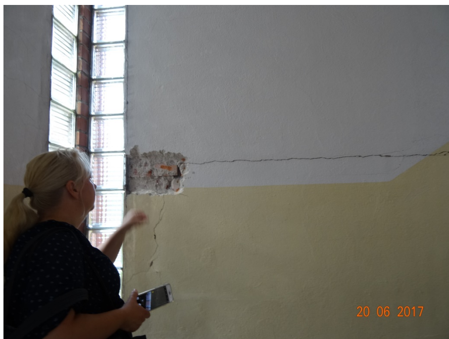
Fot. 135. Zarysowanie poziome i pionowe przy narożu nad drugim spocznikiem między piętrem i poddaszem użytkowym z istniejącą odkrywką.
