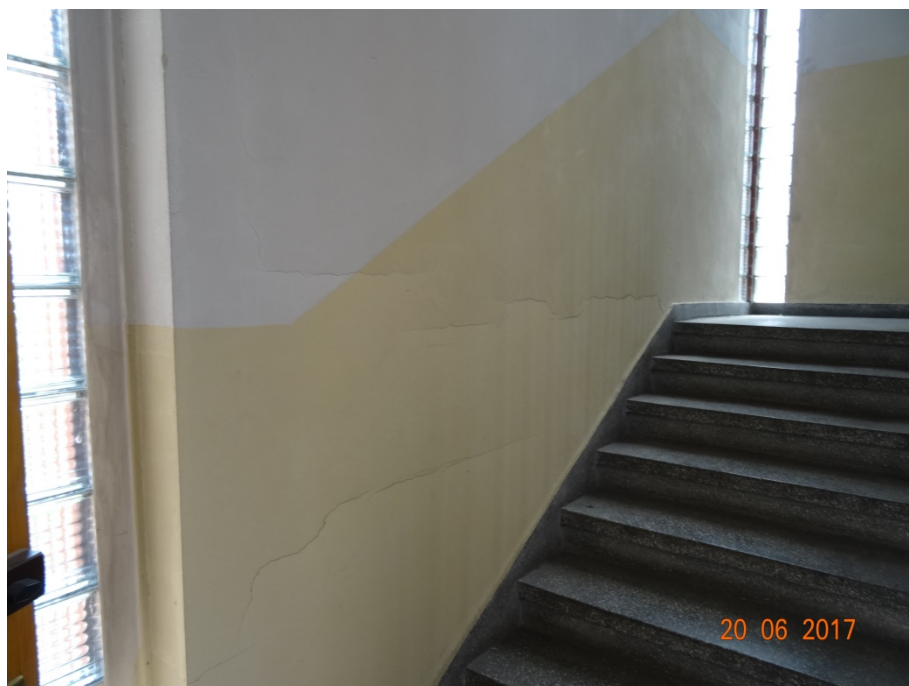
Fot. 111. Zarysowania ściany pn.-wsch. między piętrem i poddaszem użytkowym.
