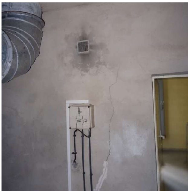
Fot. 92. Zarysowanie ściany maszynowni spowodowane oddziaływaniem dylatacji konstrukcyjnej budynku zasadniczego.
