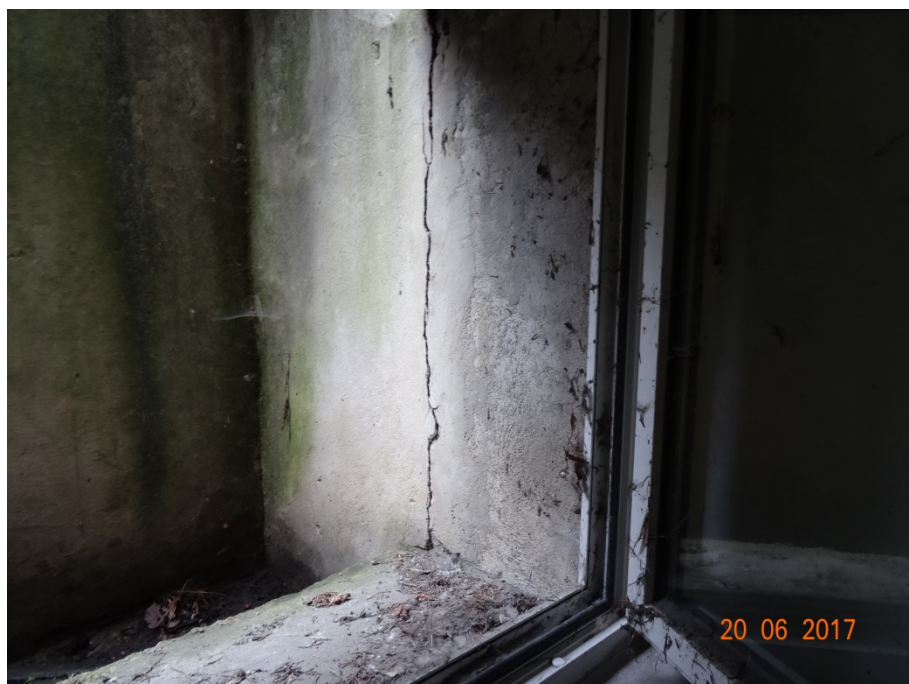
Fot. 73. Obudowy okien piwnicznych oddzielone od ściany budynku.
