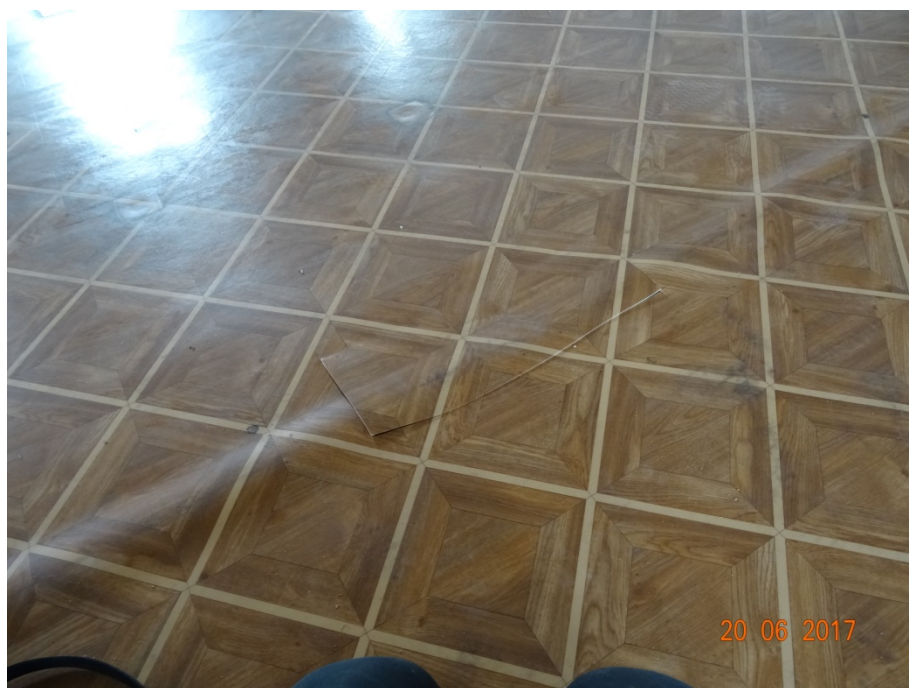
Fot. 75. Wybrzuszenie wykładziny pcw w osi podłużnej budynku.
