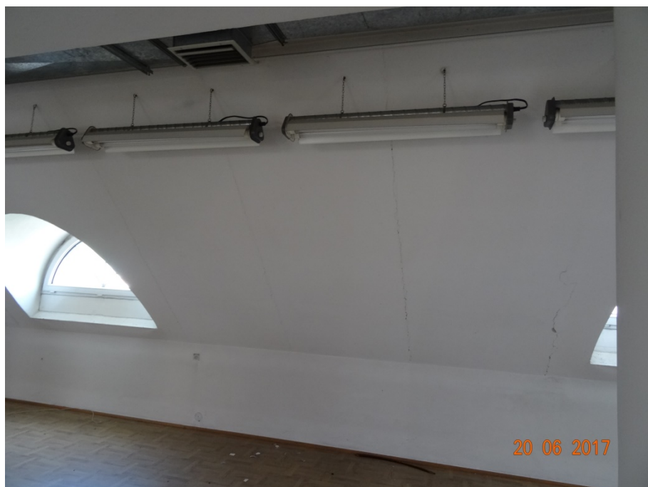
Fot. 82. Przykładowe zarysowania włoskowate w stykach płyt dachowych.
