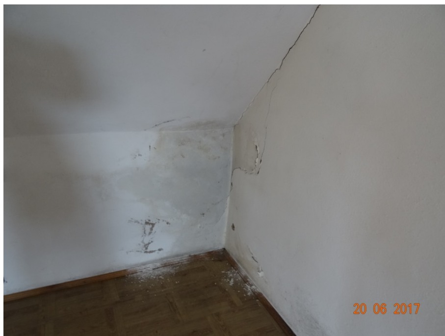
Fot. 80. Zarysowanie ukośne ściany poprzecznej przy ścianie tylnej oraz zawilgocenia ściany kolankowej.
