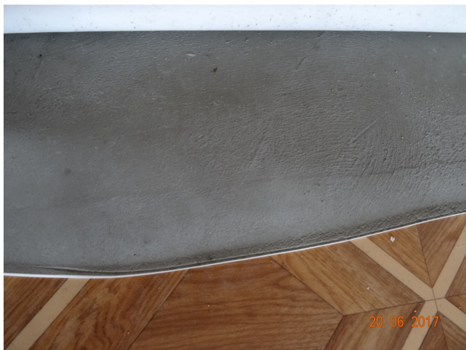
Fot. 76. Odkrywka posadzki. Podkład pod posadzkę nie wykazuje zarysowań mogących być przyczyną wybruszenia nie przyklejonej do podkładu wykładziny pcw.
