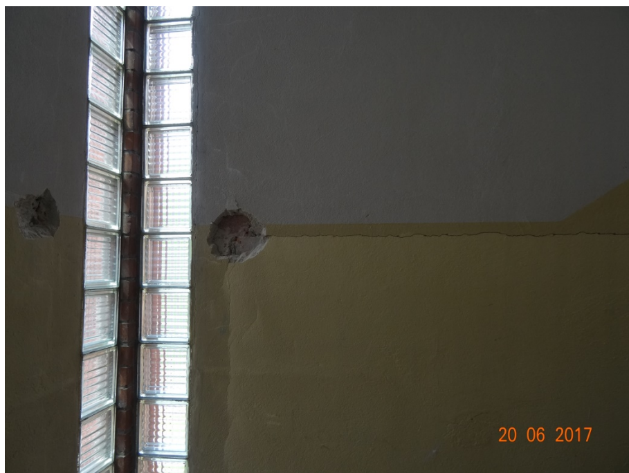
Fot. 124. Pn.-wsch. ściana klatki. Odkrywka w miejscu połączenia rys pionowej i poziomej.
