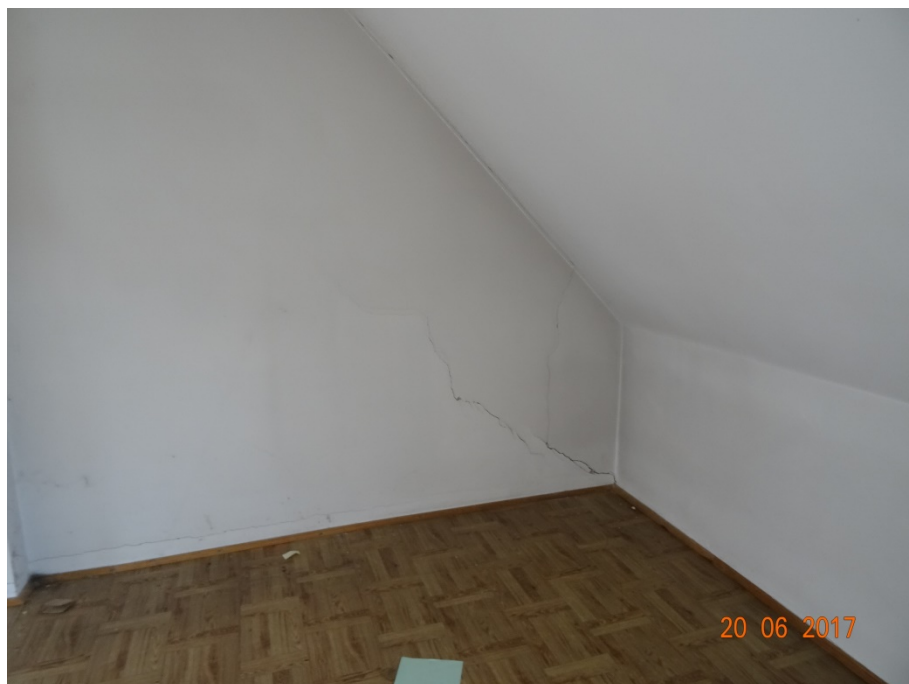
Fot. 78. Zarysowanie ukośne pn.-zach. ściany szczytowej przy ścianie frontowej.
