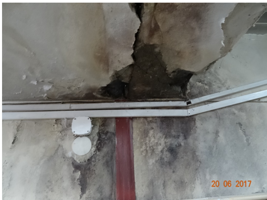
Fot. 59. Jak fot. 58, lecz zbliżenie na uszkodzenia stropu.
