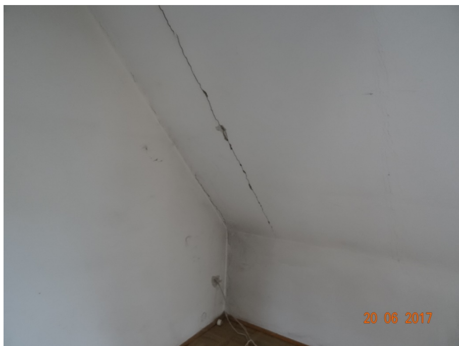
Fot. 83. Zarysowanie w styku płyt dachowych połaci frontowej przy środkowej ścianie poprzecznej.
