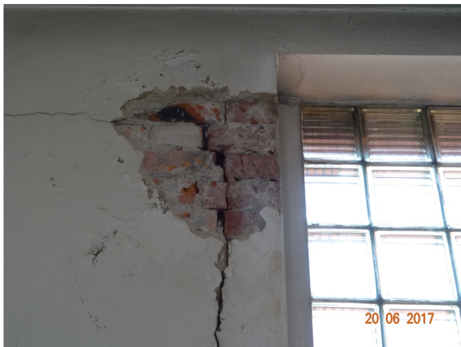
Fot. 138. Jak fot. 137, lecz zbliżenie na wykonana dawniej przez kogoś odkrywkę. Rysa pozioma w spoinie, rysa pionowa przez cegły.
