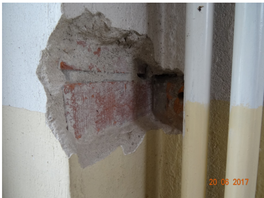
Fot. 130. Odkrywka jak na fot. 129, lecz zbliżenie. Widoczny brak przewiązania z ścianą budynku zasadniczego.
