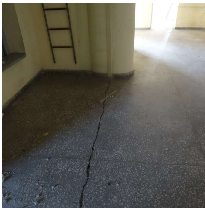
Fot. 84. Nieregularne pęknięcie posadzki lastrykowej w miejscu dylatacji konstrukcyjnej budynku – brak listew dylatacyjnych w posadzce.
