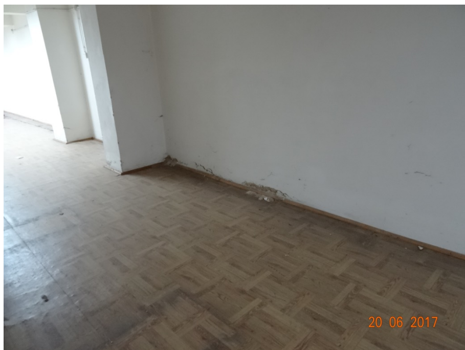
Fot. 67. Przykładowe zawilgocenie nadposadzkowych fragmentów wewnętrznych ścian piwnicznych.
