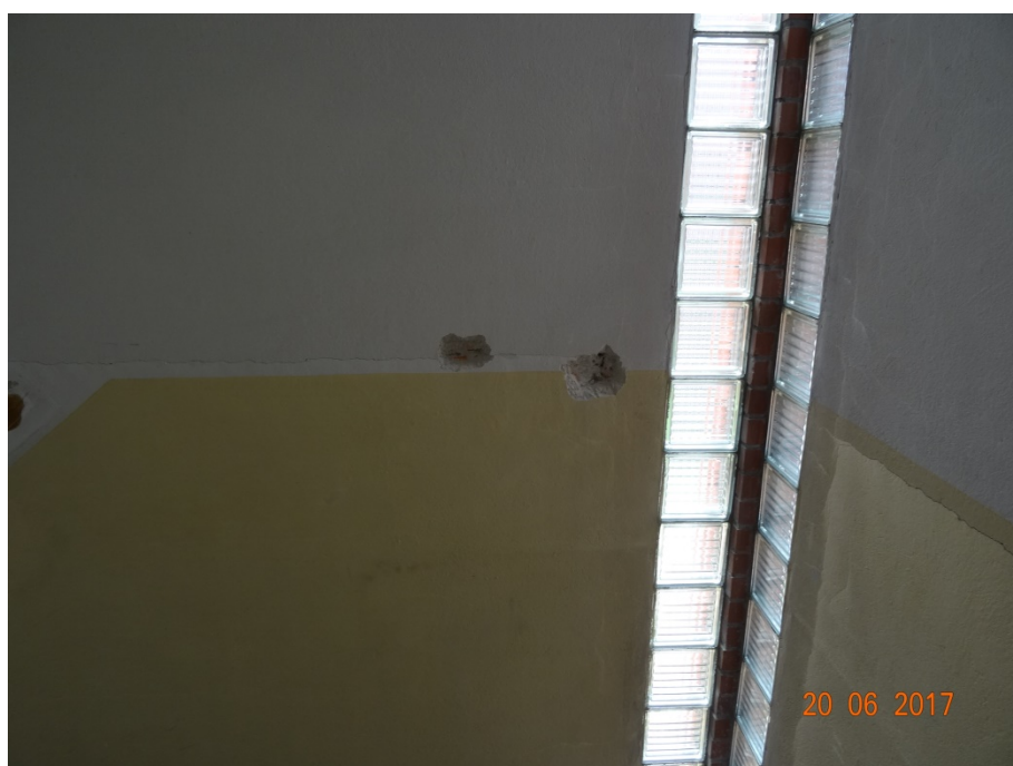
Fot. 121. Zarysowanie poziome ściany nad drugim spocznikiem pomiędzy parterem i piętrem oraz zarysowanie pionowe przy naświetlu na ścianie pn.-wsch. Widoczne miejsca wykonania odkrywek pokazanych na następnych fotografiach.
