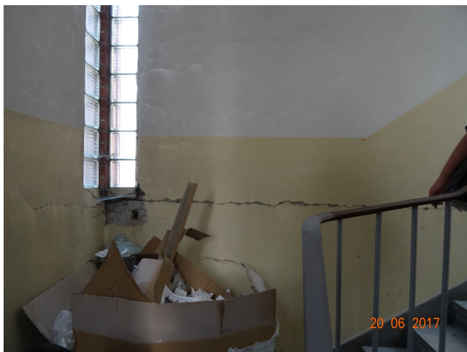
Fot. 117. Skrajna klatka schodowa. Zarysowanie poziome ściany poniżej narożnych naświetli.
