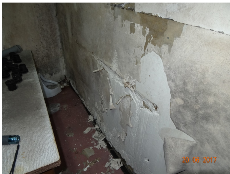
Fot. 62. Wentylatornia. „Rozmyte” płyty gipsowo-kartonowe na ścianie oddzielającej od tunelu.
