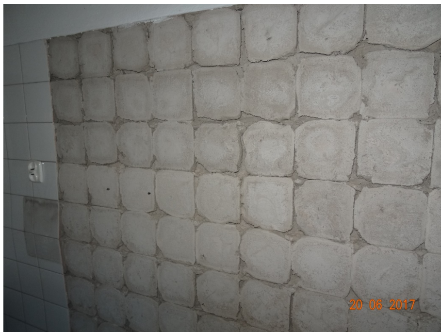
Fot. 98. Sanitariaty w piwnicy. Ubytki płytek ceramicznych.
