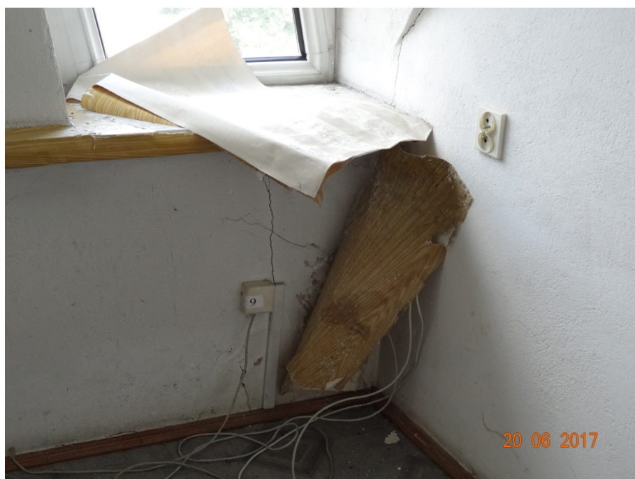
Fot. 87. Zarysowanie pionowe ścianki kolankowej pod lukarną pokazaną na fot. 82 stanowiące jej dylatację.
