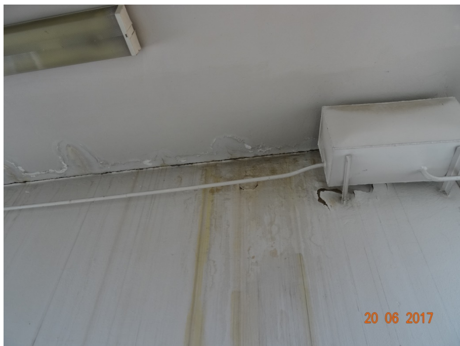
Fot. 116. Zarysowanie rozdzielcze w styku strop - ściana budynku oraz ślady przecieków wody opadowej.
