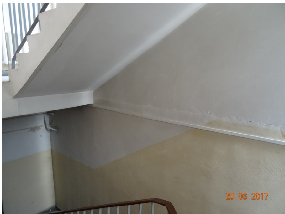
Fot. 102. Zarysowanie ściany bocznej w poziomie stropu parteru.
