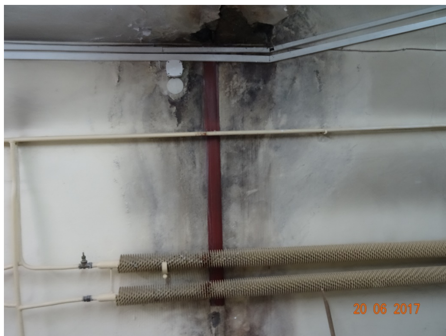
Fot. 58. Zawilgocenia ściany tunelu przy dylatacji oddzielającej od budynku zasadniczego
