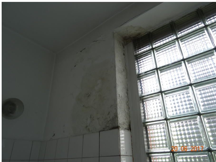
Fot. 96. Zawilgocenia ściany wodą przesączającą się przez zarysowany od zewnątrz wieniec i połączenie muru z luksferami.
