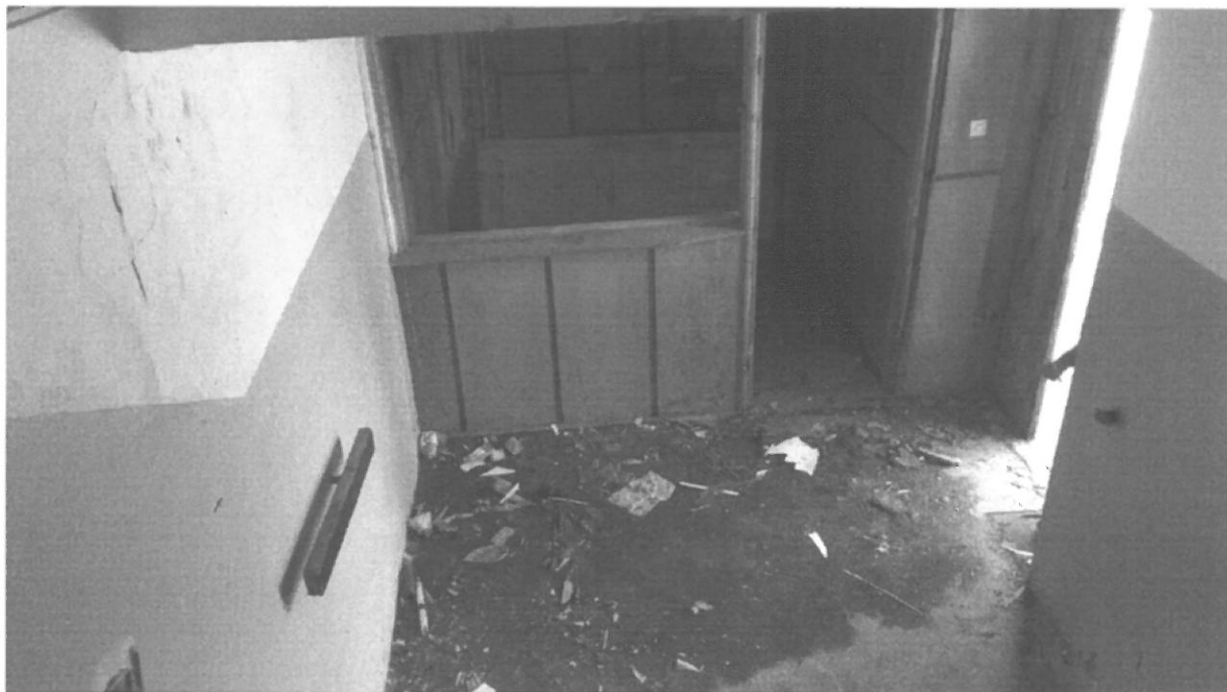
Fot. 5. Klatka schodowa. Na zdjęciu widoczne zacieki i kałuże będące wynikiem nieszczelności dachu.
